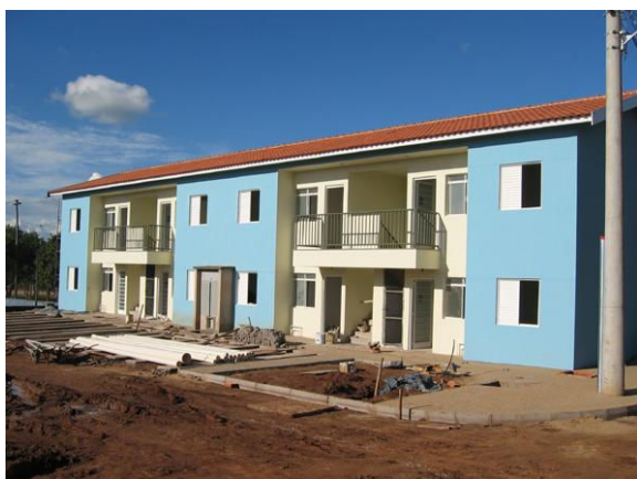
Figura 41. Residencial Oscar Barros. Fonte: http://www.rpsengenharia.com.br/obras/residenciais/132-condominio-residencial-oscar-barros.html
