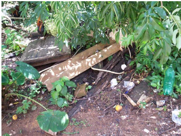
FIGURA 4.1.15 - Sistema de fossa rudimentar presente no assentamento
