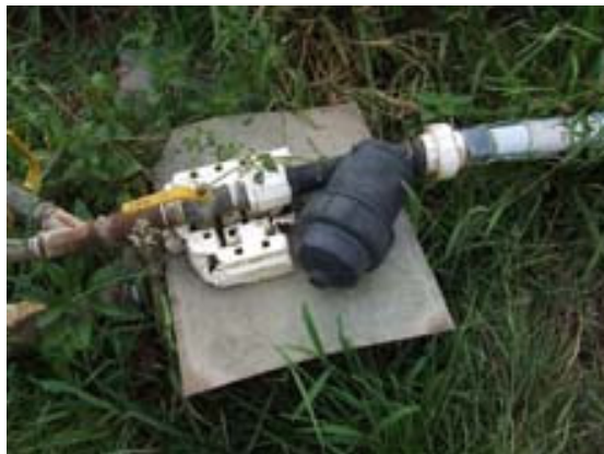
FIGURA 4.1.6 - Filtro de sistema irrigação por gotejamento de E4 (arquivo da pesquisa)
