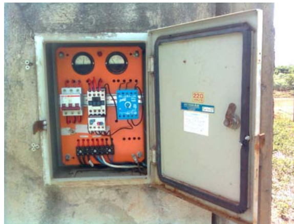
FIGURA 4.1.2 - Modelo de caixa de força de alimentação da bomba do poço coletivo, com disjuntor e automático (arquivo da pesquisa)
