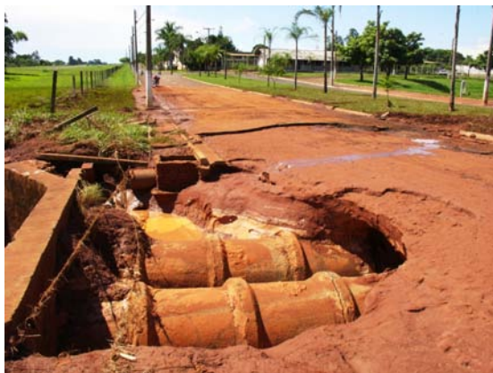
Figura 105 – Estragos na pavimentação – Avenida dos Maçons.
