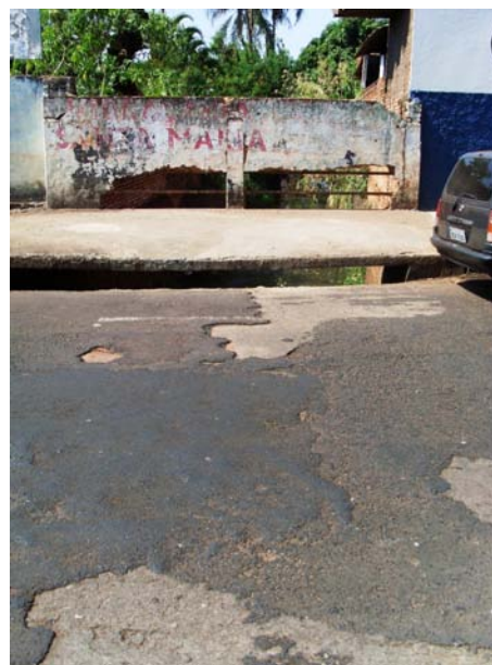
Figura 144 – Rua 26 detalhe da ponte. A destruição das paredes da ponte ocorreram devido a ação da água nas últimas enchentes. (Elaboração e foto: Watanuki Filho, A., Ago, 2008).
