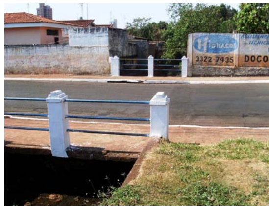
Figura 132 – Ponte de travessia – Rua 30 Verifica-se a partir da Rua 30, a canalização e retificação mais acentuada do córrego. A ponte de travessia não suporta as vazões do córrego em períodos de cheia. Resultado área de transbordamento nos períodos de chuva (Elaboração e foto: Watanuki Filho, A., Ago, 2008).
