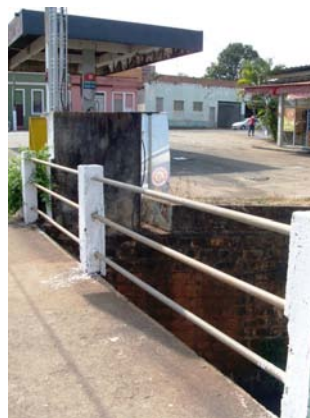
Figura 173 – Posto de combustível Rua 18 Ponto de possíveis problemas ambientais. (Elaboração e foto: Watanuki Filho, A., Ago, 2008)
