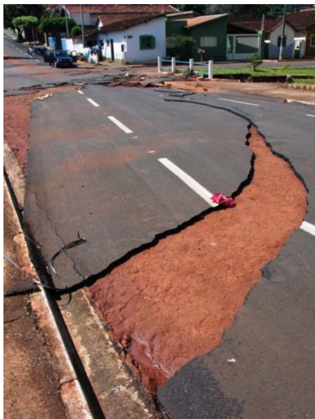
Figura 145 – Rua 32 – retirada da capa asfáltica pela chuva (Elaboração e foto: Watanuki Filho, A., Ago, 2008)
