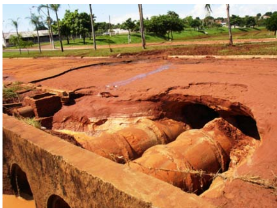
Figura 107 – Situação da tubulação que alimenta as represas.
