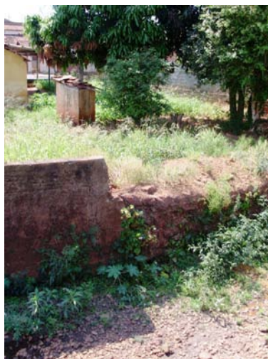
Figura 128 – Fronteiras d’água susceptíveis a erosão e lixiviação. (Elaboração e foto: Watanuki Filho, A., Ago, 2008)
