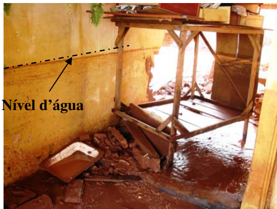
Figura 196 – Destruição e desapropriações ocasionadas pela chuva. (Elaboração: Watanuki Filho, A., Ago, 2008, Foto: SAAE/Barretos, Fev, 2007)
