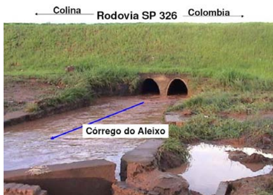
Figura 103 – Galerias sob o aterro da rodovia – estragos da chuva.
