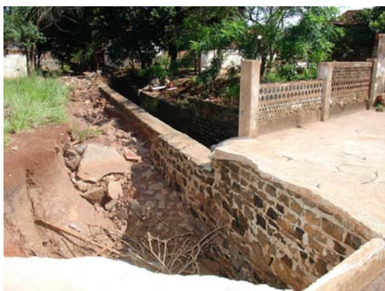
Figura 191 – Destruição e erosões causadas pela chuva (Avenida 11 Rua 14x12) (Elaboração: Watanuki Filho, A., Ago, 2008, Foto: SAAE/Barretos, Fev, 2007)
