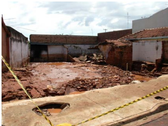
Figura 193 – Destrução das construções pela ação da água (Rua 24) (Elaboração: Watanuki Filho, A., Ago, 2008, Foto: SAAE/Barretos, Fev, 2007)
