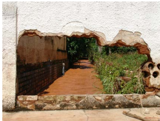
Figura 194 – Estragos no muro que isola o córrego das vias de trânsito (Rua 24). (Elaboração: Watanuki Filho, A., Ago, 2008, Foto: SAAE/Barretos, Fev, 2007)
