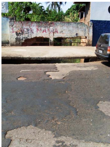
Figura 154 – Rua 26 – Ponte sobre o córrego (Elaboração e foto: Watanuki Filho, A., Ago, 2008)
