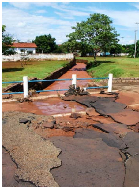
Figura 146 – Placas de asfalto levadas pela água. (Elaboração e foto: Watanuki Filho, A., Ago, 2008).
