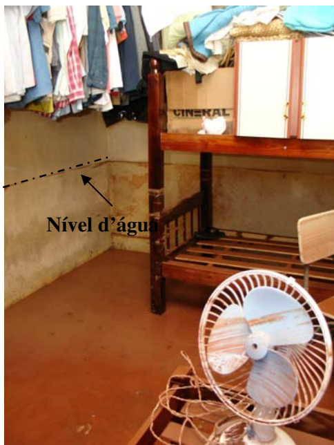
Figura 195 – Residência atingida pela enchente (Rua 14) (Elaboração: Watanuki Filho, A., Ago, 2008, Foto: SAAE/Barretos, Fev, 2007)
