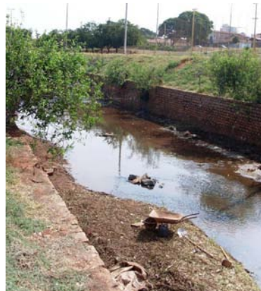
Figura 204 – Problemas com assoreamento (Elaboração: Watanuki Filho, A., Ago, 2008)
