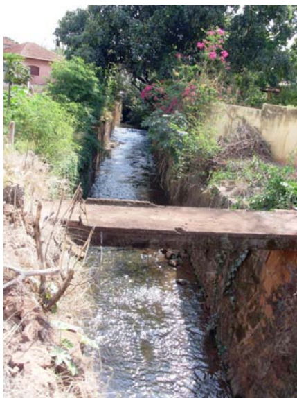
Figura 177 – Ponte sobre o córrego A passagem permite a interligação de lotes vazios e permite o depósito de entulhos. (Elaboração e foto: Watanuki Filho, A., Ago, 2008)
