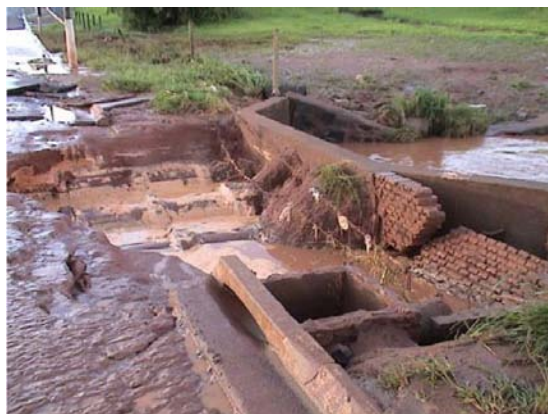
Figura 104 – Avenida doas Maçons após chuva – Fev, 2007.
