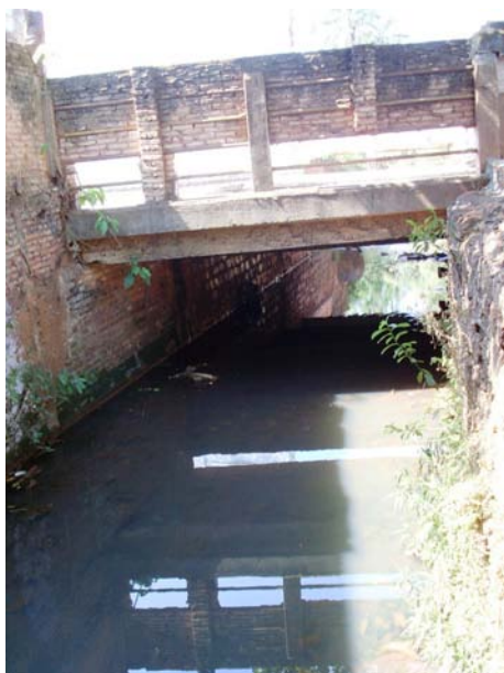
Figura 143 – Ponte da Rua 26. Estrutura muito próxima ao fundo do córrego, o volume de água, em períodos de chuva, acabava sendo superior ao que este foi dimensionando. (Elaboração e foto: Watanuki Filho, A., Ago, 2008)
