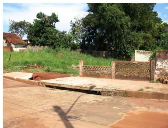
Figura 192 – Vista do local atingido pela chuva. (Elaboração: Watanuki Filho, A., Ago, 2008, Foto: SAAE/Barretos, Fev, 2007)
