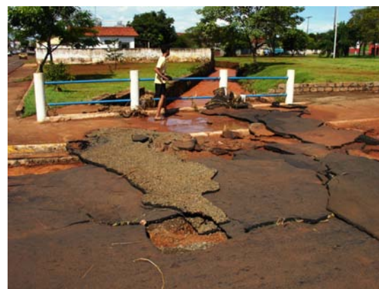
Figura 151 – Destruição da pavimentação. (Elaboração: Watanuki Filho, A., Ago, 2008, Foto: SAAE/Barretos, Fev, 2007)
