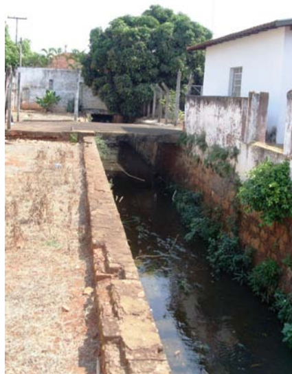
Figura 163 – Córrego atravessando propriedade particular A construção da residência ocupa suas várzeas, aprisiona o córrego e arrasa a paisagem. (Elaboração e foto: Watanuki Filho, A., Ago, 2008)
