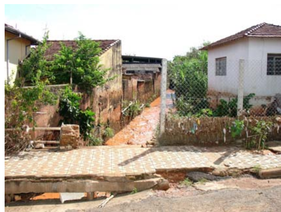
Figura 190 – Destruição do guarda corpo e do passeio de pedestres (Elaboração: Watanuki Filho, A., Ago, 2008, Foto: SAAE/Barretos, Fev, 2007)
