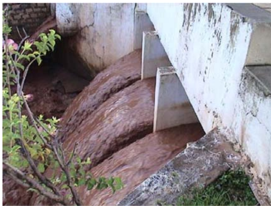
Figura 115 – Volume de água nas galerias de acesso à segunda represa (Elaboração Watanuki Filho, A., Ago, 2008, Foto: Rocha, B. L.A., Fev, 2008, disponível em: < http\\:www.outorga.com.br >, acesso em Setembro/2008)
