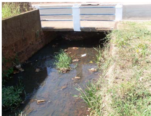
Figura 133 – Resíduos e vegetação dentro do córrego
