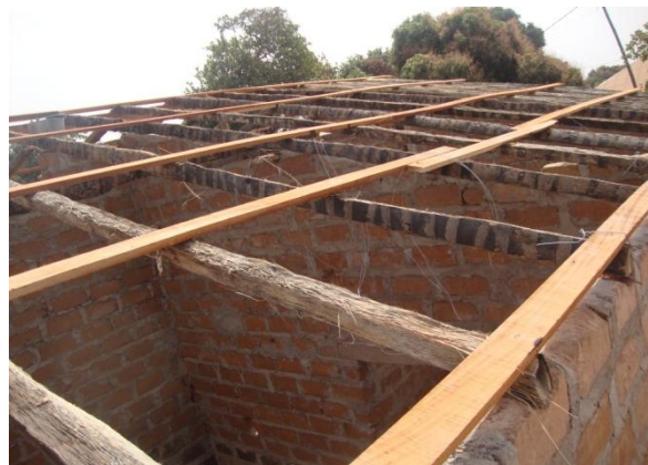
Figura 43: Madeiramento (estrutura da cobertura com barras de cibe e madeiras/ripas). Cobertura de duas águas.
