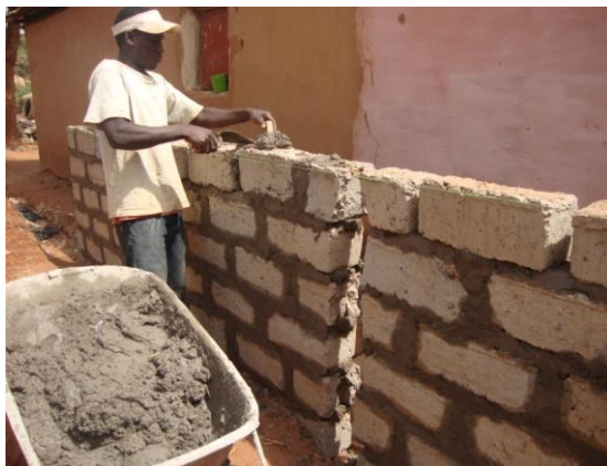
Figura 46: 1ª Fiadas em blocos de concreto do sistema misto de alta eficácia.
