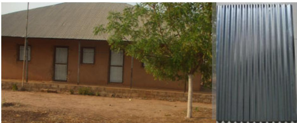
Figura 13: Casa com telha de metal em Bula, Guiné-Bissau, 2009. Telha de metal em destaque.
