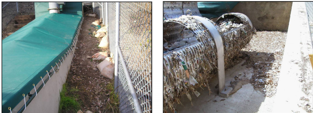
Figura 72: Dispositivo de gradeamento de resíduos sólidos (poluição difusa) em rodovias da Califórnia, EUA. Fonte: Caltrans, 2009.
