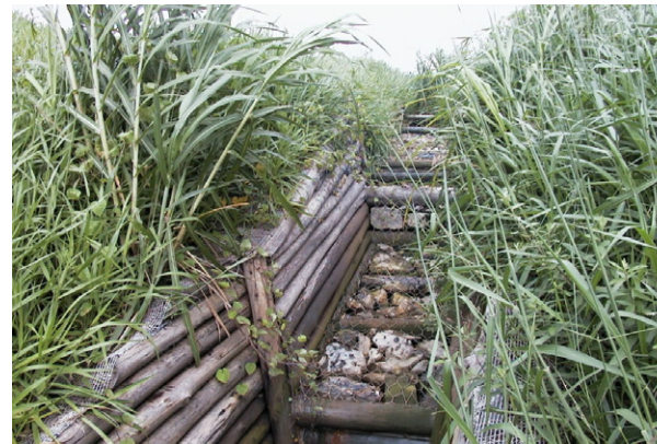
Figura 101: Escada hidráulica de madeira e pedra 7 meses após o término da obra - Alexânia-GO. Fonte: Vertical Green, 2010.
