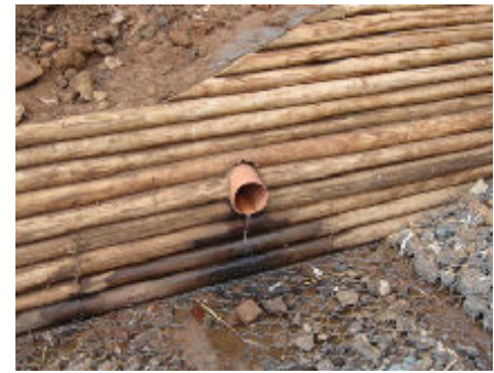
Figura 142: Adequação a afloramento d'água. Fonte: Silva Leme Engenharia, 2006.
