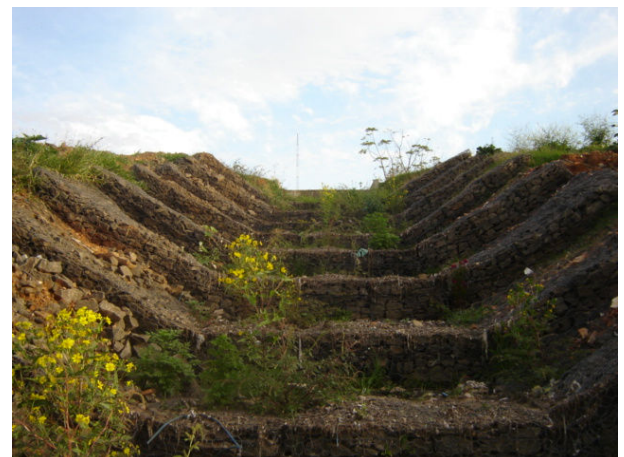
Figura 97: Escada hidráulica de gabião manta com desenvolvimento de vegetação após 90 dias de sua conclusão. Fonte: Silva Leme Engenharia, 2008.
