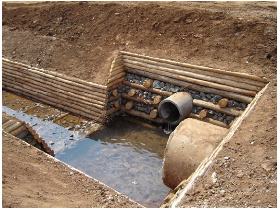
Figura 102: Caixa dissipadora de energia de madeira roliça, pedras e tela metálica no córrego Tijuco Preto, São Carlos-SP. Fonte: Silva Leme Engenharia, 2008.
