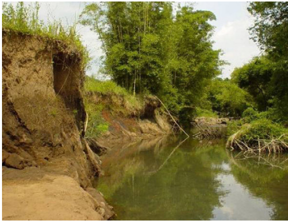
Figura 106: Margem erodida no arroio Guardador (jan/2003). Fonte: Sutili, 2007.
