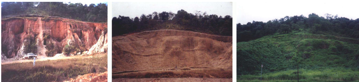
Figura 84: Remodelação da encosta erodida e instalação de biomanta erosiva, antes, durante e três meses depois da intervenção. Fonte: Deflor.
