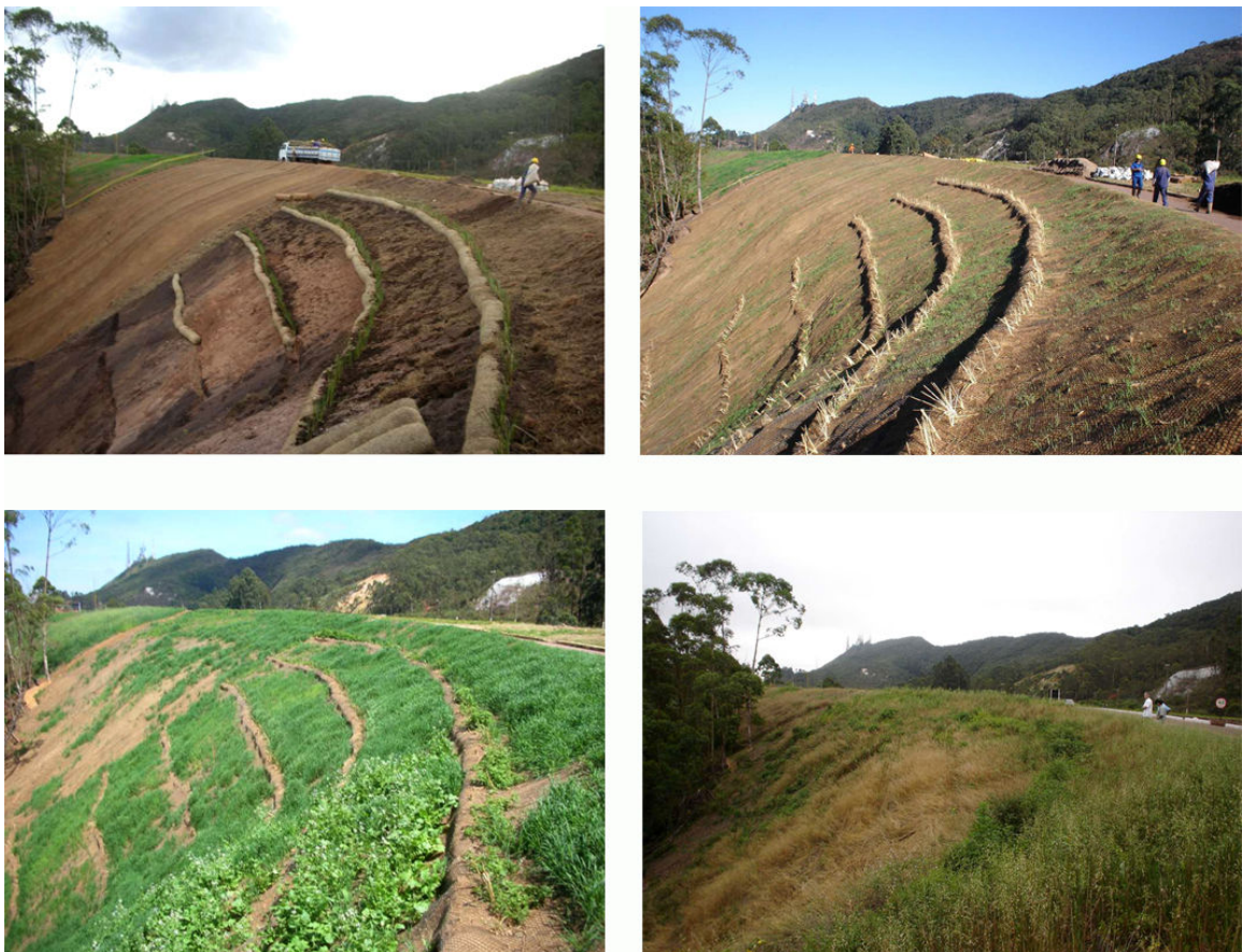
Figura 89: Etapas da recomposição da encosta com aplicação de biomanta, biorretentores e vegetação.
