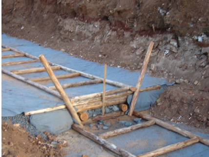
Figura 137: Colocação das primeiras toras de Eucalipto sobre o colchão drenante. Fonte: Silva Leme Engenharia, 2006.
