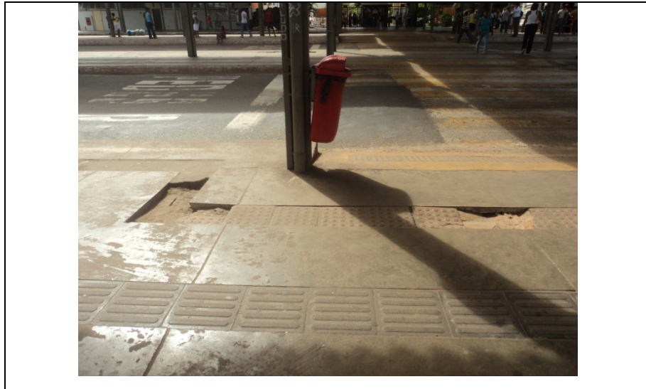
Figura 18 - Piso deteriorado e com partes inexistentes no terminal da Praia Grande Fonte: autor, 2011.
