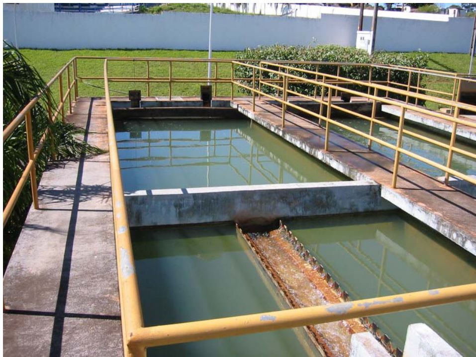
FIGURA 4.6 Decantadores convencionais ETA Cardoso
