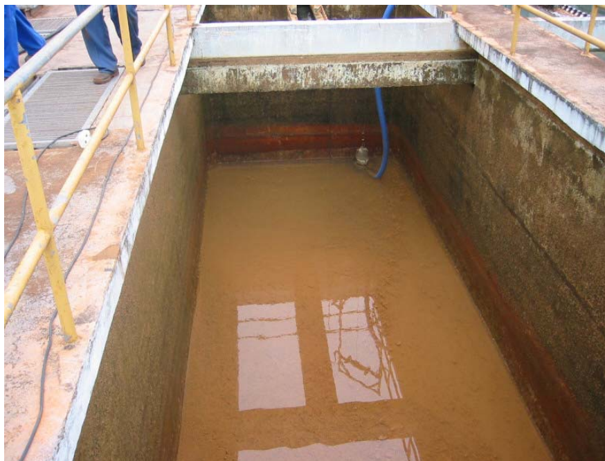
FIGURA 6.16 Camada de lodo após lançamento da água clarificada para os filtros
