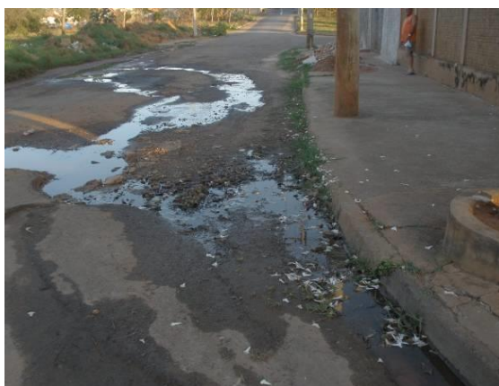
FOTOS B.2.45., B.2.46., e B.2.47 . Pavimentação danificada pela falta de captação de águas pelas bocas de lobo (foto do autor).
