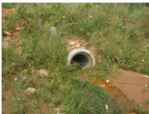
FOTOS B.7.56., B.7.57., B.7.58., B.7.59. B.7.60., B.7.61. e B.7.62. Drenos instalados pelo DAE para escoamento de água entre a faixa de domínio da ferrovia e o aterro de entulhos (foto do autor).
