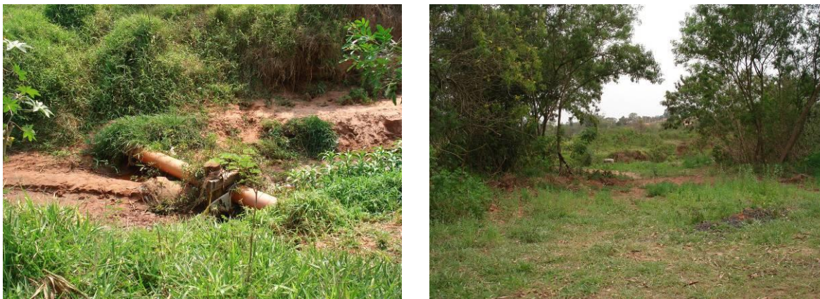
FOTOS B.3.19. e B.3.20. Poço de visita dos Interceptores executados pelo DAE para a coleta do esgoto dos loteamentos cuja bacia de contribuição é o Córrego Barreirinho (foto do autor).
