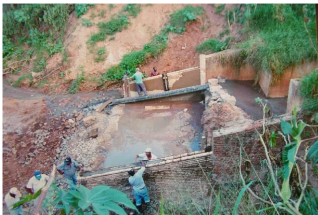
FOTOS B.2.5. Execução do dissipador de energia, seguindo projeto de recuperação da erosão. Fonte: Prefeitura Municipal de Bauru – SEPLAN.
