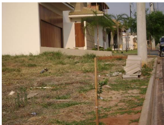
FOTOS B.5.25., B.5.26. B.5.27., B.5.28. e B.5.29. Rampas de acessibilidade instaladas no loteamento. Observa-se que os passeios na permitem acessibilidade a cadeirantes, idosos, crianças e demais pessoas com mobilidade reduzida e necessidades especiais (fotos do autor).
