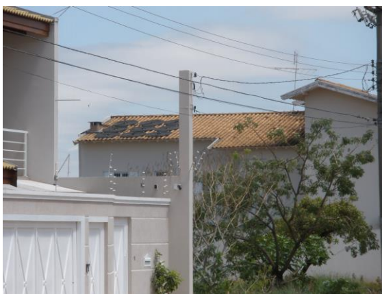
FOTOS B.7.51. Instalação de aquecedor solar no imóvel. Uso de energia alternativa (foto do autor).
