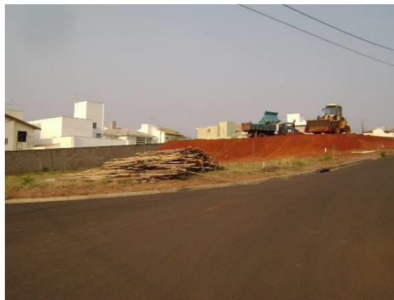
FOTOS B.5.16., B.5.17., B.5.18., B.5.19., e B.5.20. Distribuição dos lotes no Loteamento. Observa-se a distribuição dos lotes, sendo alguns deles com necessidade de muro de arrimo (foto do autor).
