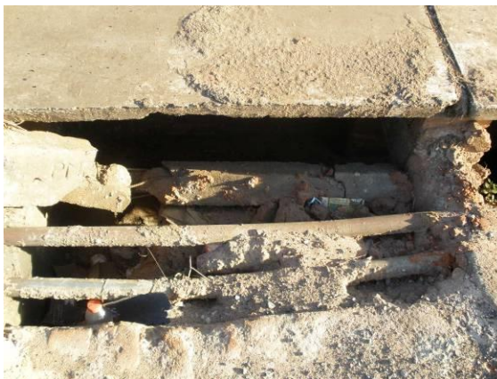
FOTOS B.1.69., B.1.70., B.1.71. B.1.72., B.1.73., B.1.74., B.1.75., B.1.76. e B.1.77. Bocas de lobo necessitando de limpeza e manutenção no Residencial Quinta Ranieri em sua porção externa (foto do autor).
