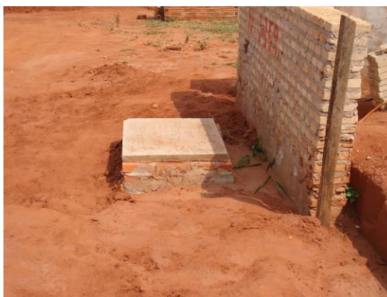
FOTO B.4.17. Caixa de Inspeção de esgoto, localizada no local destinado a passeio. As obras de rede de coleta esgoto do empreendimento ainda não foram recebidas pela autarquia municipal (foto do autor).
