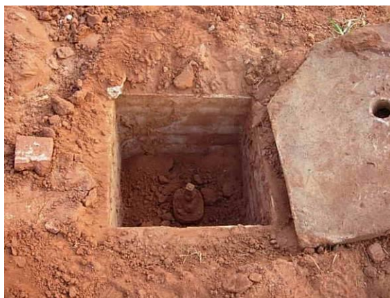
FOTO B.5.122. Caixa para ligação de água no imóvel (foto do autor).
