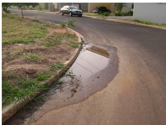
FOTO B.5.76. Acúmulo de água junto a guia (foto do autor).
