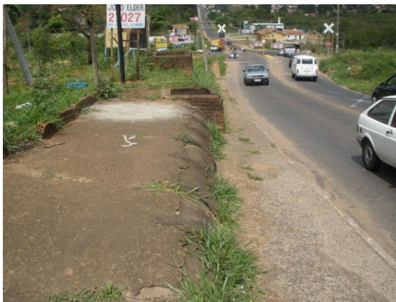
FOTOS B.7.72. Tubulação da galeria de águas pluviais acima do passeio para alcançar a cota para despejar a água no córrego (foto do autor).
