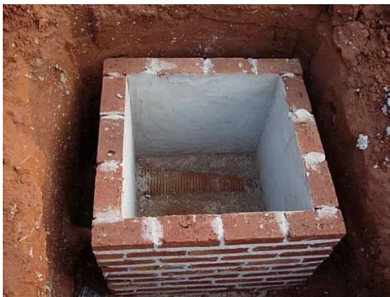
FOTO B.5.123. Caixa para ligação de esgoto no imóvel (foto do autor).
