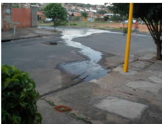
FOTOS B.2.36., B.2.37. e B.2.38. Bocas de lobo que não captam as águas (foto do autor).
