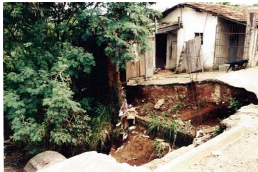
Figura 7 - Risco isolado de desabamento removida Fonte: EMDHAP (1993 a 1998)
