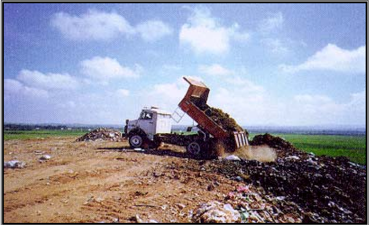
Figura 3.5: Resíduos sendo descarregados em trecho de uma trincheira (DMLU/PMPA). Fonte: Bidone, Povinelli (1999).
