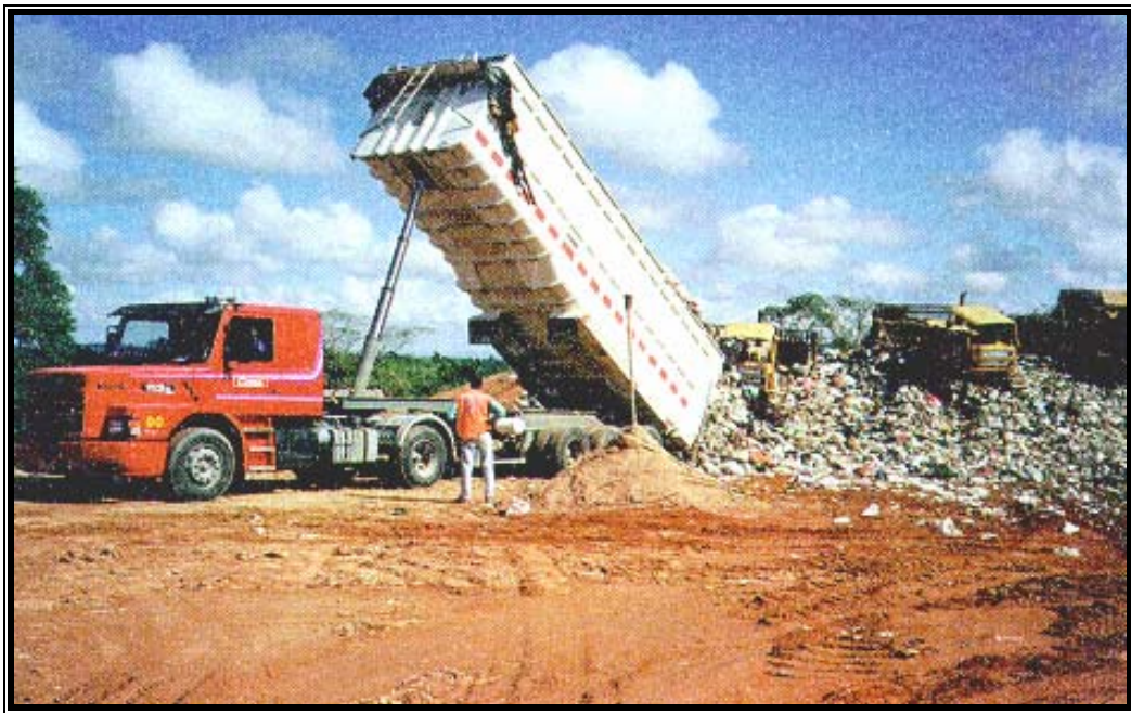
Figura 3.11: Execução de uma célula de aterro sanitário em área com resíduos compactados sendo cobertos por uma camada de solo (DMLU/PMPA).
