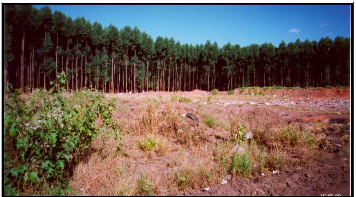
Figura 2.2 Solo inadequado para a disposição de resíduo, com feições erosivas ao longo do talude. Fonte: Autor.
