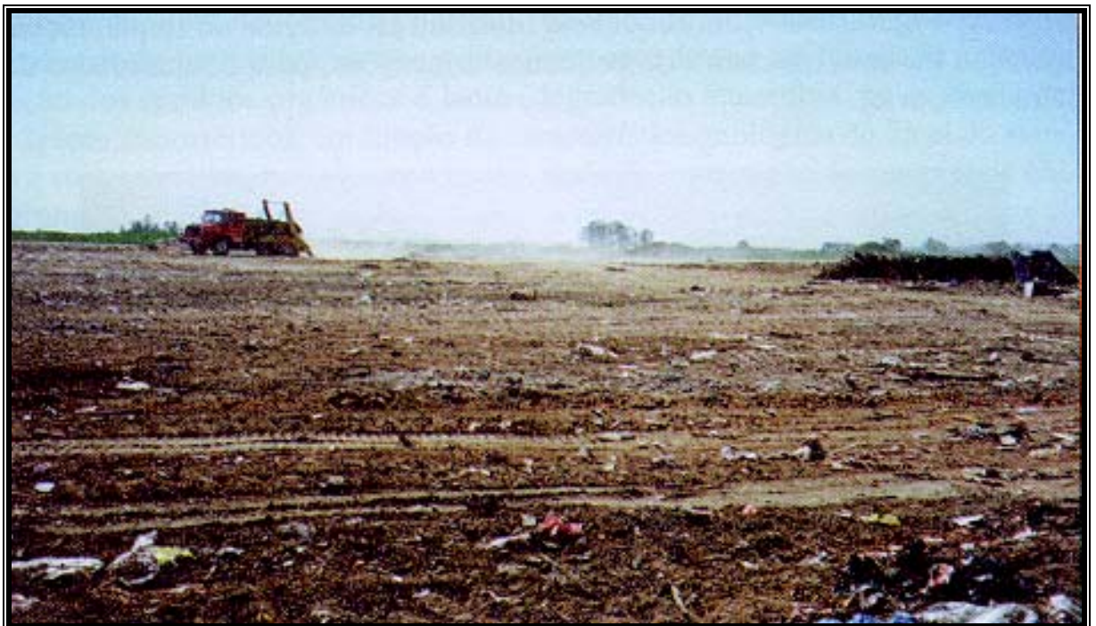
Figura 3.6: Acabamento superficial de uma trincheira de pequeno porte (DMLU/PMPA). Fonte: Bidone, Povinelli (1999).
