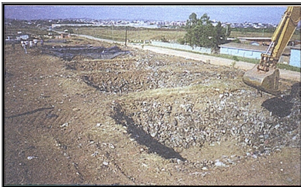
Figura 3.4: Escavação de trincheira de pequeno porte com a utilização de retroescavadeira. Fonte: Bidone, Povinelli, (1999).
