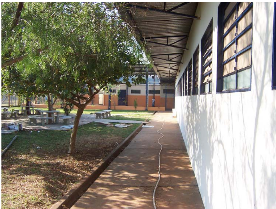
Figura 6.14 – Canaleta de piso do setor didático
