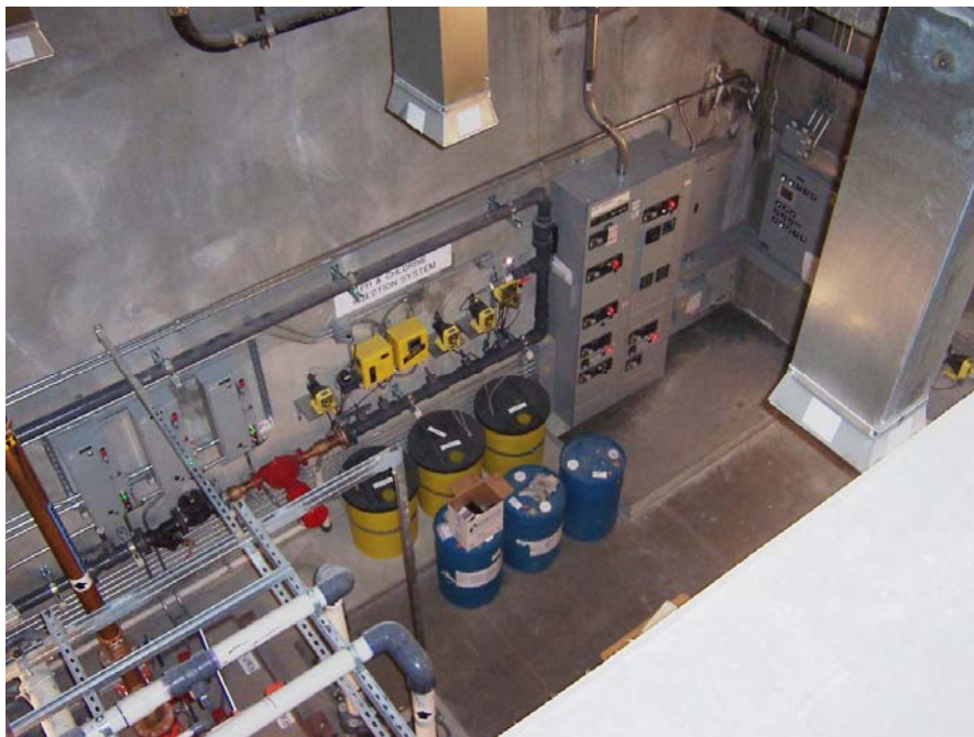
Figura 4.20 – Unidade tratamento de água do sistema
