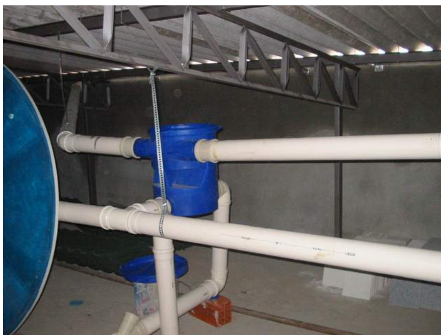
Figura 4.91 – Vista interna de sistema instalado em hotel
