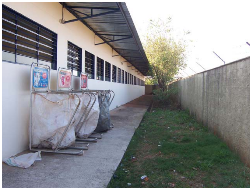
Figura 6.17 – Beiral da cobertura sem calha e piso sem canaleta (vista lateral do setor didático)
