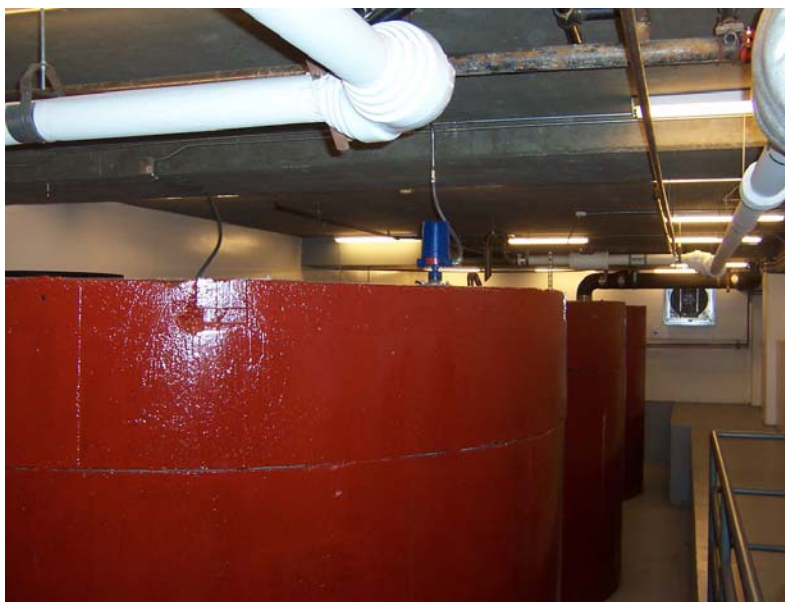
Figura 4.25 – Vista geral dos reservatórios de água pluvial
