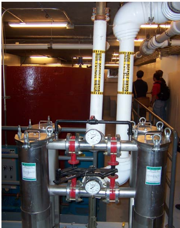
Figura 4.27 – Filtros e rede de distribuição
