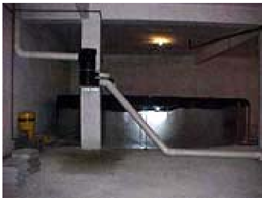
Figura 4.71 – Reservatório de água pluvial no subsolo
