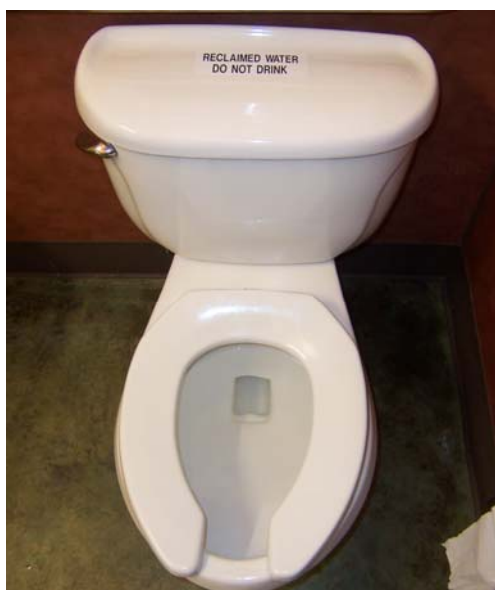
Figura 4.30 – Bacia sanitária abastecida com água pluvial
