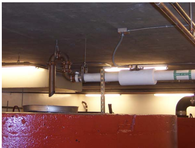
Figura 4.26 – Dispositivo de entrada de água potável na cisterna
