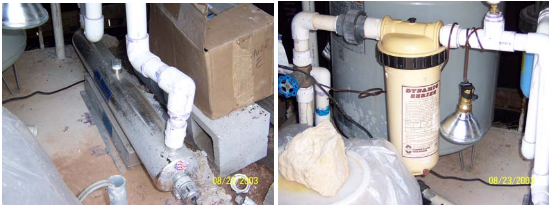
Figura 4.55 – Dispositivo de luz ultravioleta e filtro da unidade de tratamento
