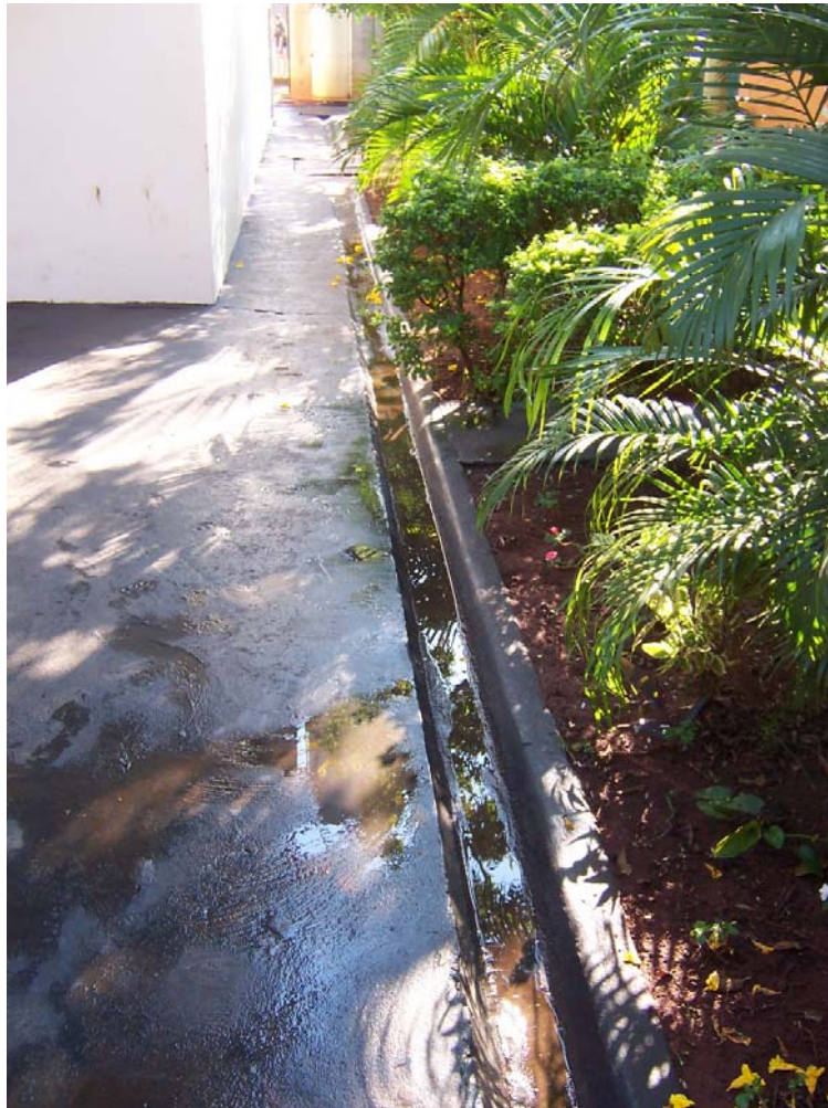
Figura 6.13 – Canaleta de piso do setor de serviços
