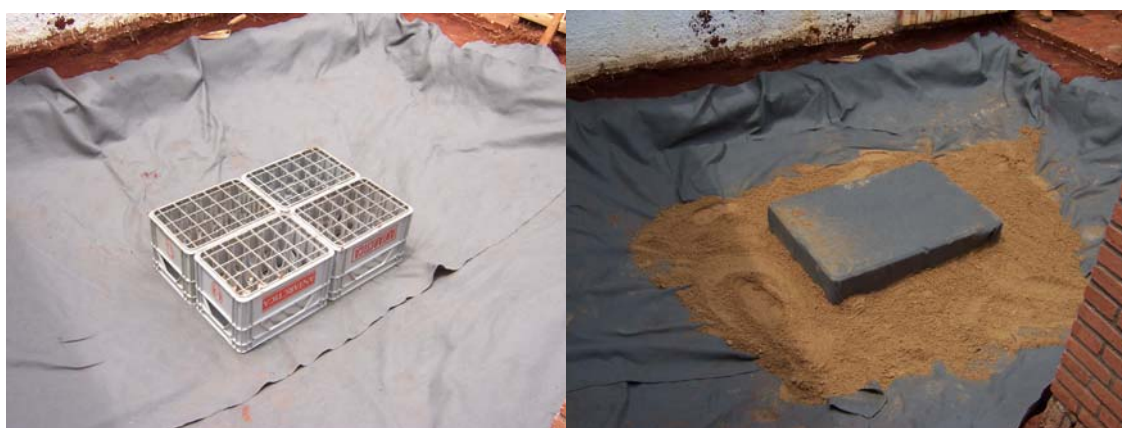
Figura 4.86 - Vista do reservatório permeável instalado
