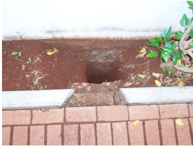
Figura 4.83 - Dreno de escoamento superficial
