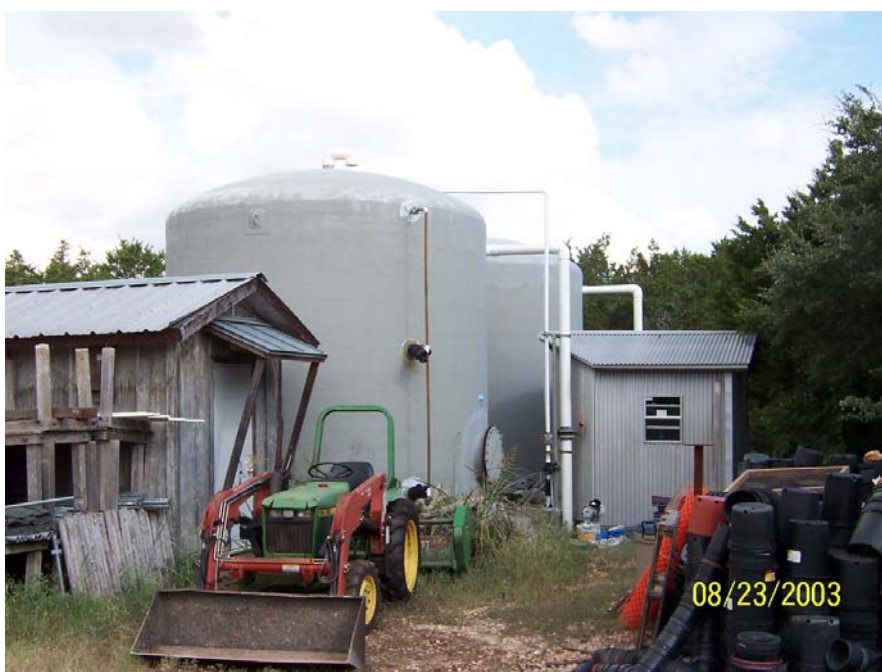
Figura 4.59 – Reservatórios principais em chapa de aço
