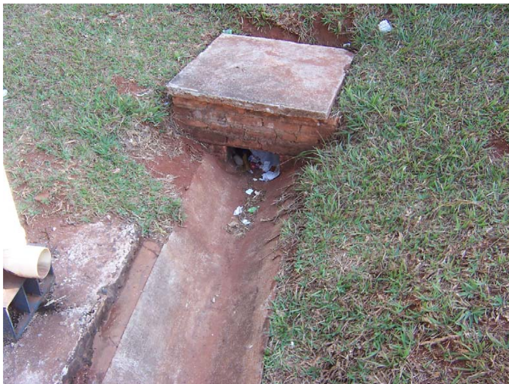
Figura 6.6 – Acúmulo de resíduos sólidos no sistema de drenagem
