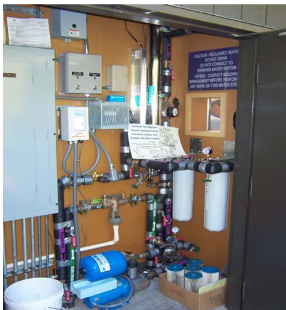
Figura 4.32 – Unidade de tratamento da água
