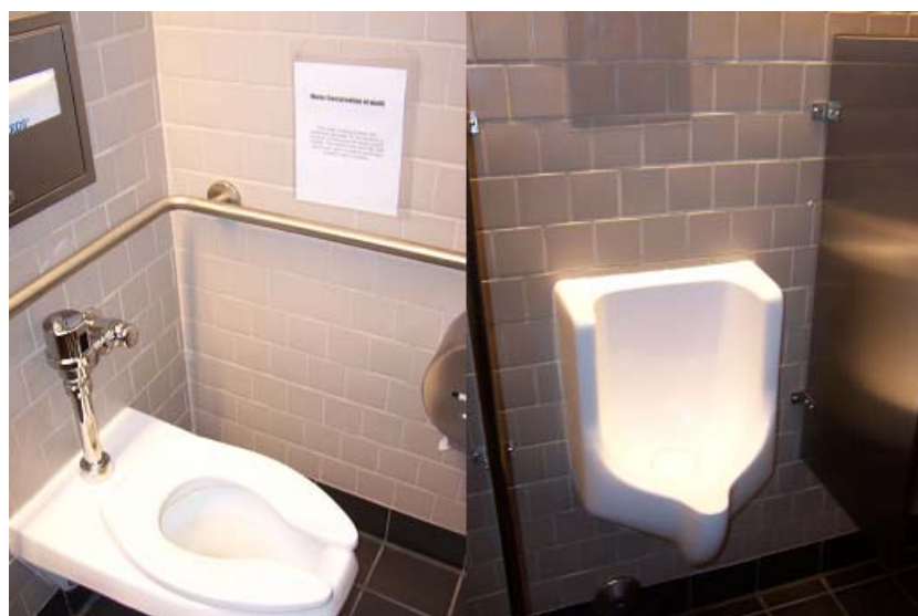
Figura 4.18 – Bacia sanitária abastecida com água pluvial e mictório seco
