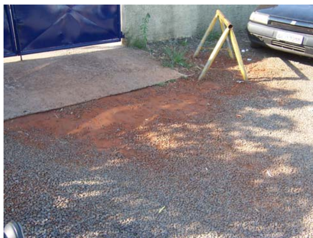
Figura 6.23 – Patologia da pavimentação
