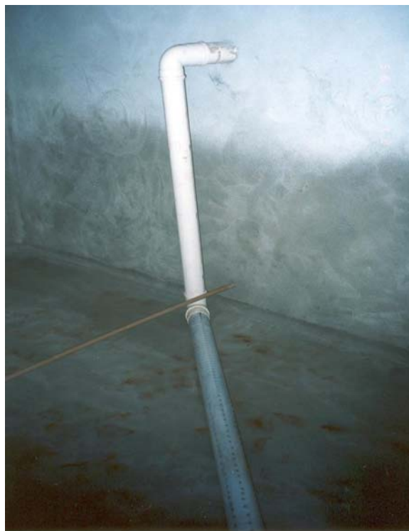
Figura 4.76 - Dispositivo de entrada de água na cisterna e dissipador de energia
