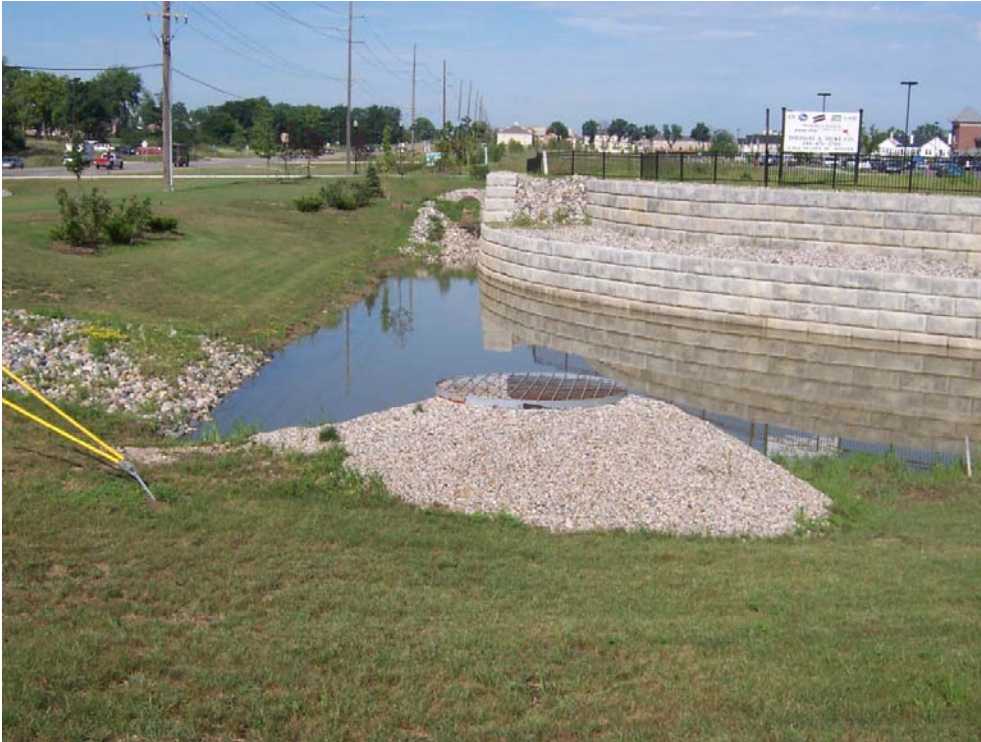
Figura 4.63 – Reservatório para detenção da água superficial
