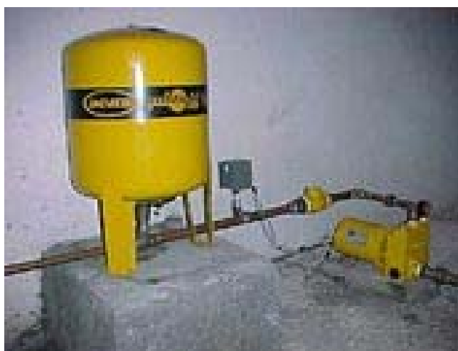
Figura 4.72 – Pressurizador da rede de distribuição
