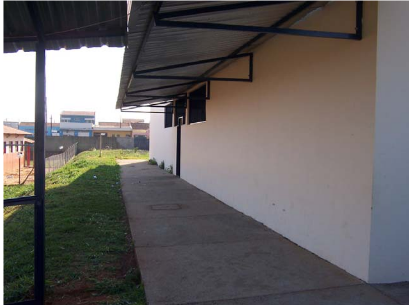
Figura 6.16 – Beiral da cobertura sem calha e piso sem canaleta (vista da parte posterior do setor didático)
