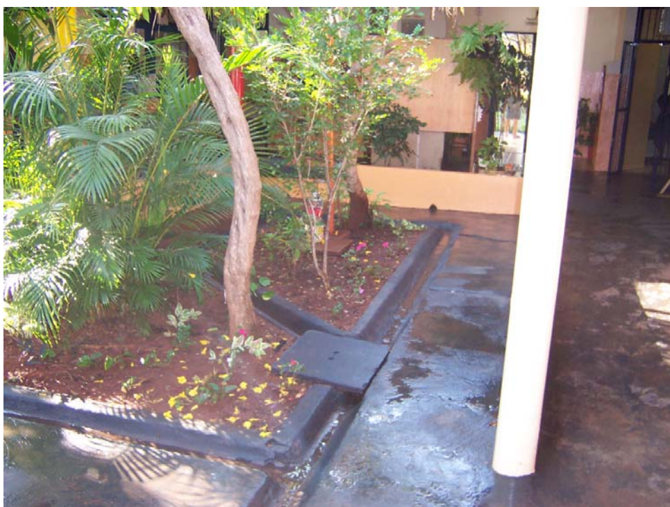
Figura 6.15 – Canaleta de piso do setor administrativo
