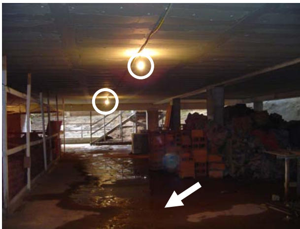
Figura 5.19 – Lâmpadas em área de circulação sem proteção contra impactos mecânicos.
