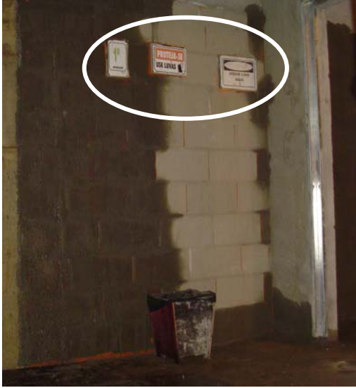
Figura 5.6 – Sinalização de segurança nos pavimentos tipo.
