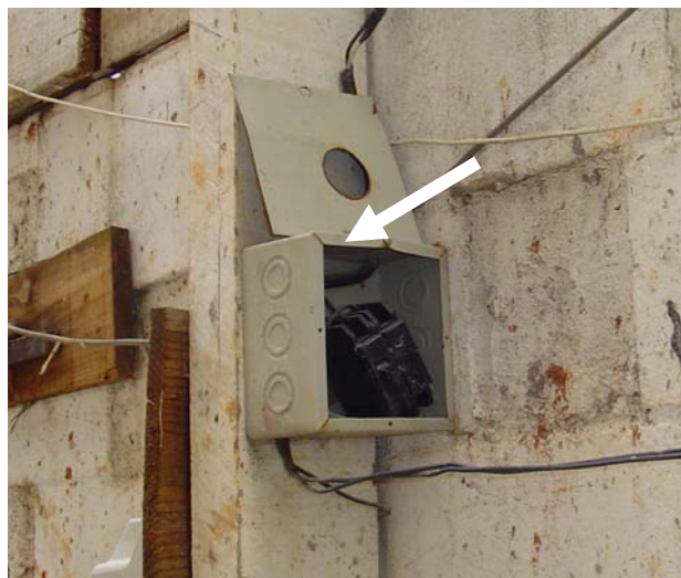
Figura 5.10 - Contatos expostos de disjuntor.
