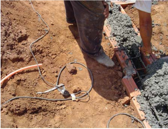
Figura 4.14 - Isolação de condutores deficiente e condição de exposição agravada por possibilidade de contato com a água.
