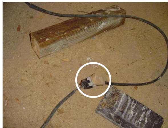
Figura 5.12 – Emenda com resistência mecânica não adequada.
