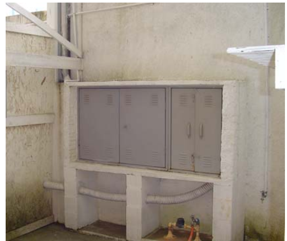
Figura 5.4 - Quadro elétrico de entrada externo em boas condições.
