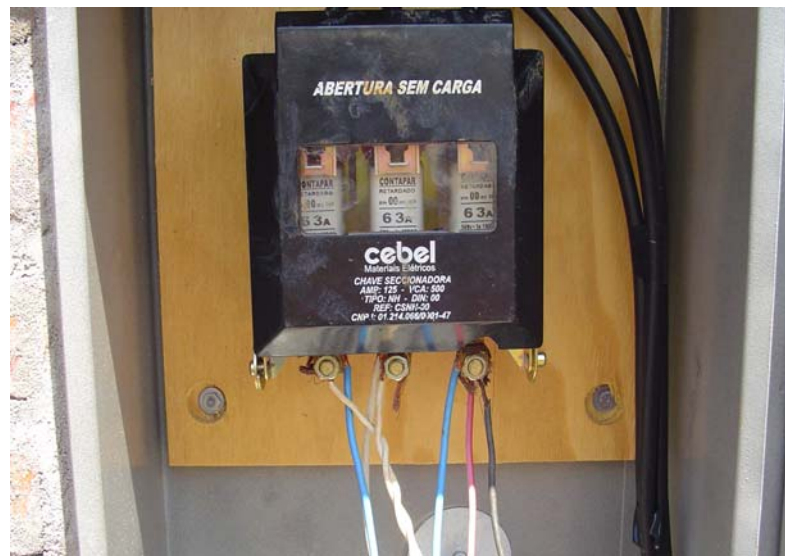
Figura 4.6 - Condutores e contatos energizados expostos.
