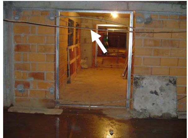
Figura 5.16 - Obstrução de circulação por parte de um eletroduto instalado em local impróprio.
