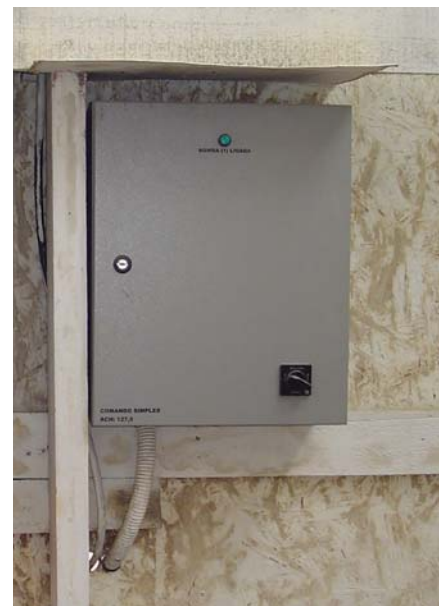
Figura 5.28 - Chave de comando da bomba de recalque.
