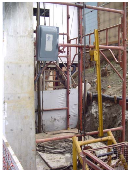
Figura 5.26 - Chave elétrica blindada convenientemente instalada em elevador de carga.
