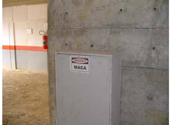
Figura 5.7 - Sinalização de emergência e primeiros socorros.
