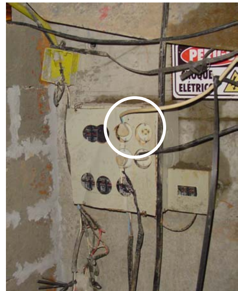
Figura 5.36 - Painel de acesso a tomadas para máquinas e equipamentos em geral sem proteção contra desconexão acidental.
