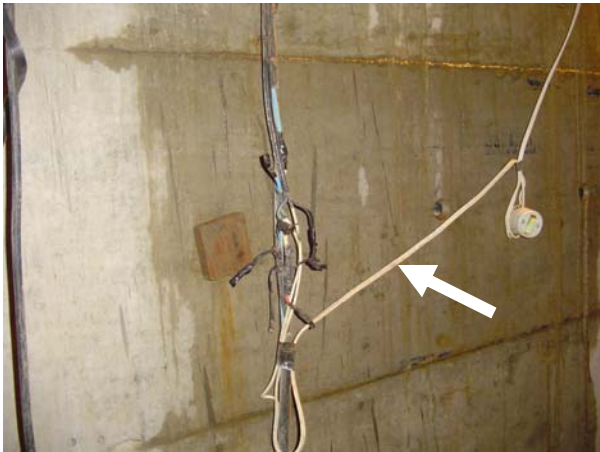
Figura 5.15 - Condutores com isolamento não adequado para o ambiente de trabalho úmido.
