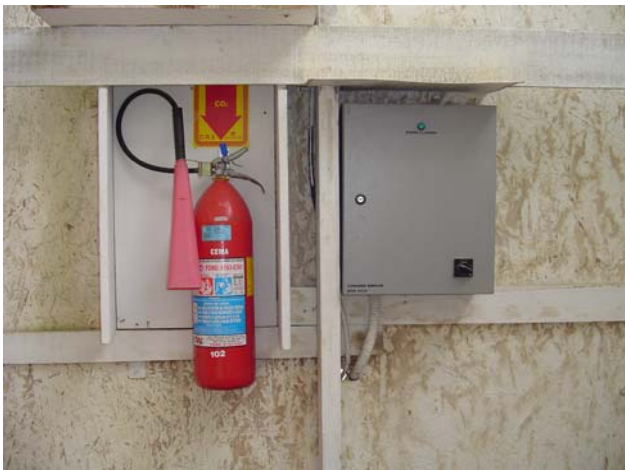
Figura 5.3 - Equipamento de prevenção contra incêndios.
