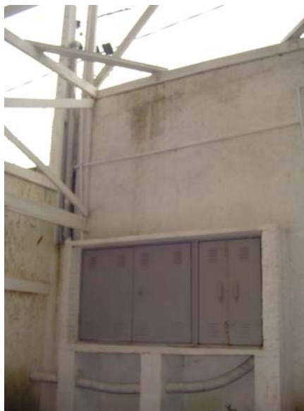
Figura 5.30 - Entrada de energia do canteiro de obras em baixa tensão.
