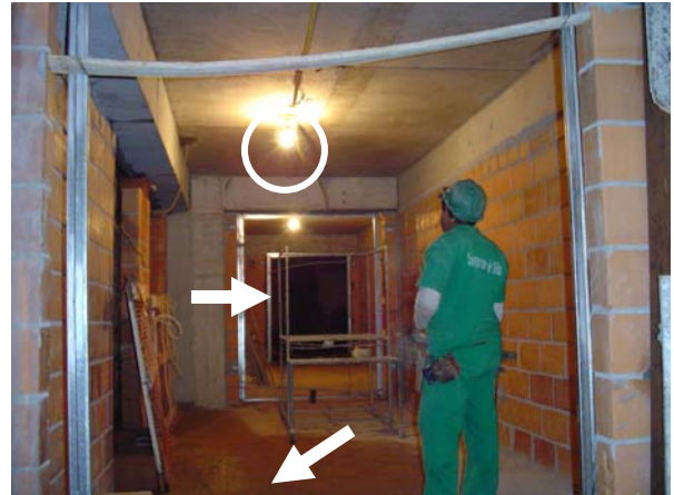
Figura 5.22 – Lâmpada sem proteção contra impactos mecânicos e andaime metálico em contato com umidade do piso.
