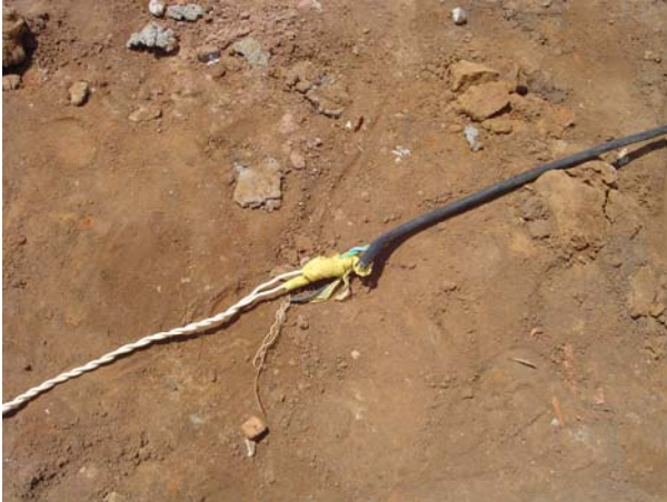
Figura 4.11 - Falha de isolamento em um cabo de extensão.
