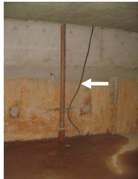
Figura 5.24 - Ocorrência de fiação de circuito provisório inoperante ou dispensável.
