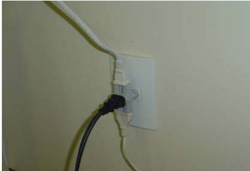
Figura 4.13 - Ligação de vários aparelhos em apenas uma tomada gerando possível sobrecarga.
