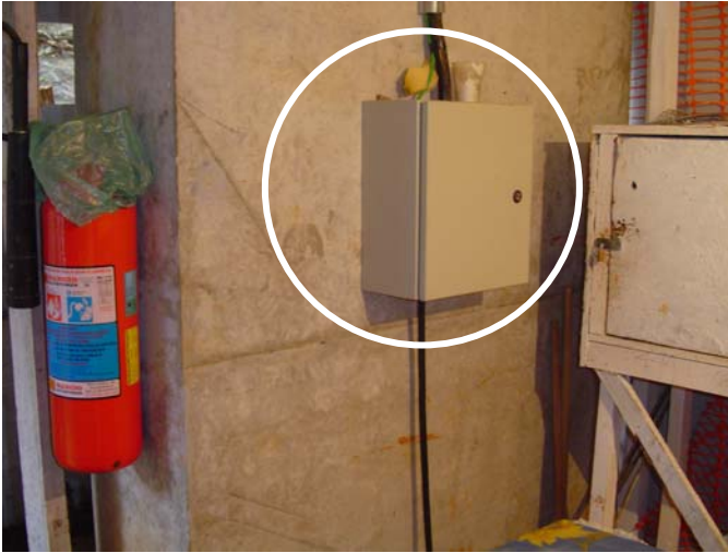
Figura 5.33 - Quadro elétrico metálico em boas condições e fechado.
