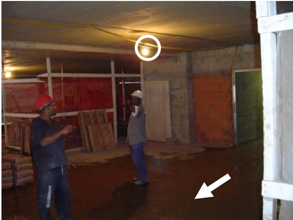
Figura 5.21 – Lâmpadas em área de circulação sem proteção contra impactos mecânicos.
