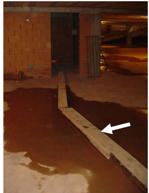
Figura 5.18 – Proteção mecânica de circuito elétrico não adequada, em caso de exposição à umidade.
