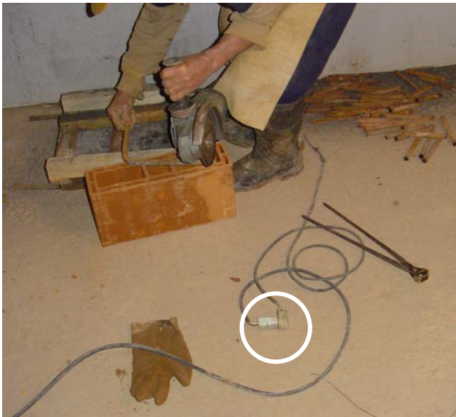
Figura 5.35 - Ligação plugue-tomada, não adequada, de uma máquina policorte em operação.
