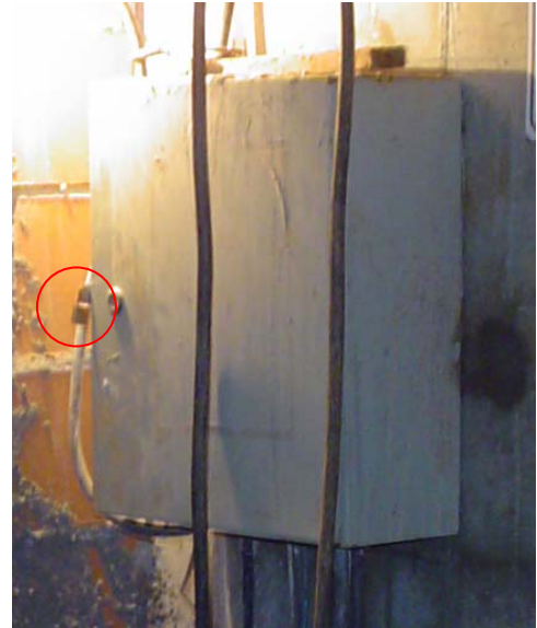
Figura 5.34 - Quadro elétrico trancado por cadeado.
