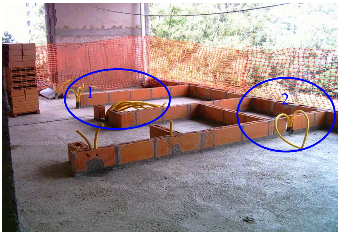
FIGURA 5.9 – Interferência alvenaria – instalações elétricas Fonte: Empresa pesquisada (Obra A)
