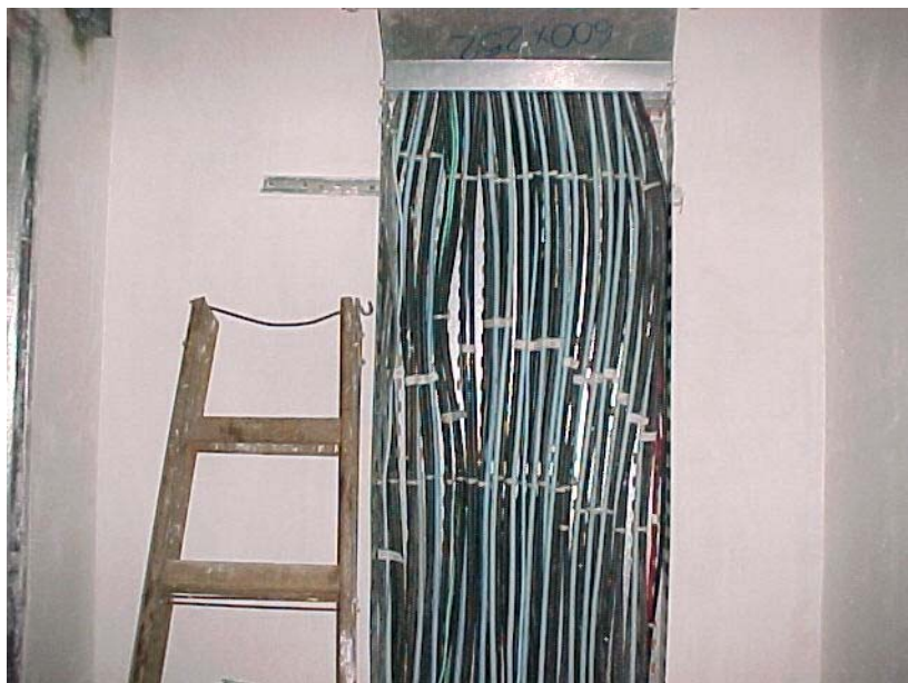
FIGURA 5.19 – Shaft para prumada de cabos elétricos Fonte: Empresa pesquisada (Obra B)
