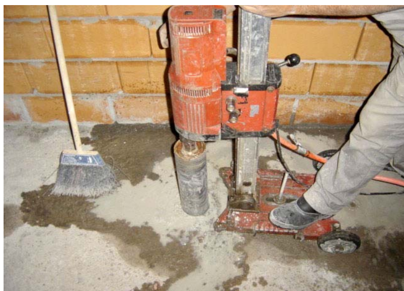
FIGURA 5.20 – Furo na laje por meio de máquina extratora Fonte: Empresa pesquisada (Obra B)
