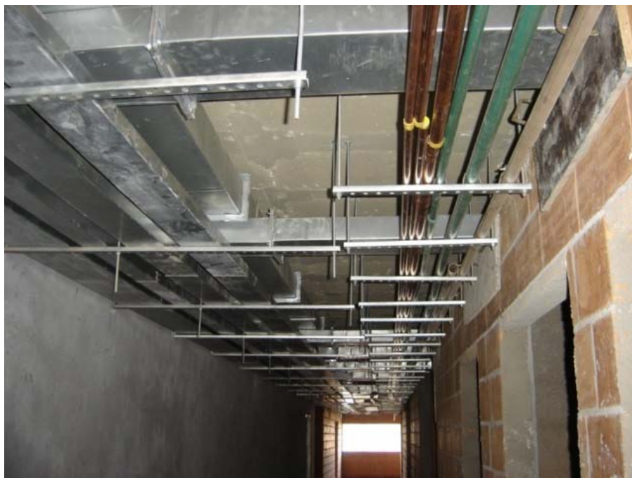
FIGURA 5.29 – Interferências de tubulações e dutos para caminhamento da rede de distribuição de esgoto até prumada Fonte: Empresa pesquisada (Obra C)
