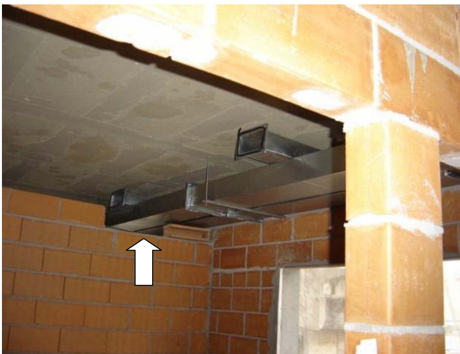
FIGURA 5.26 – Vão insuficiente para duto de ar condicionado Fonte: Empresa pesquisada (Obra C)
