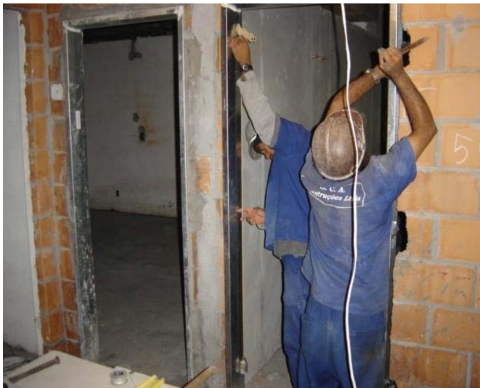
FIGURA 5.28 – Assentamento de batentes metálicos após execução da alvenaria Fonte: Empresa pesquisada (Obra C)
