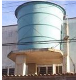
Figura 3.10 - Reservatório em fibra de vidro
