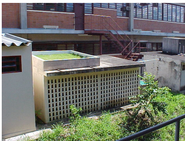
Figura 3.11: Vista geral do protótipo de cobertura verde
