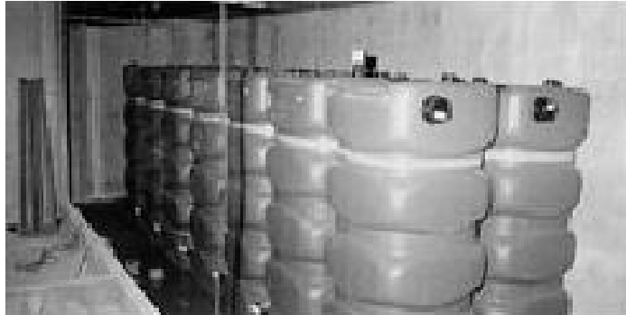
Figura 4.16 Cisternas em PEAD da cidade Meillonas
