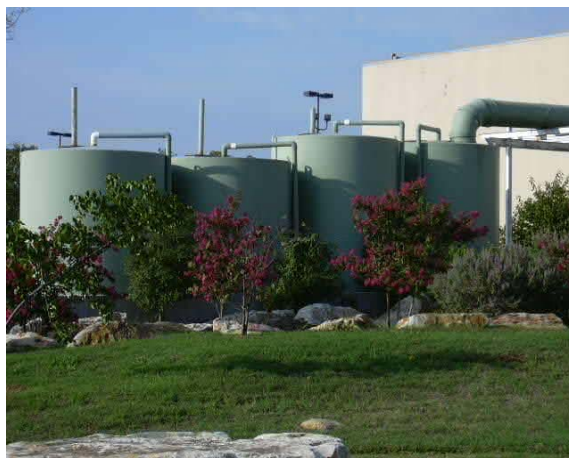
Figura 4.2 Cisternas metálicas - H.E.B. Grocery
