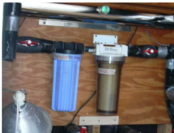
Figura 4.8 Sistema de esterilização/filtragem da água pluvial – Stay ‘n’ Play Pet Ranch
