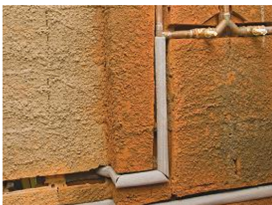
FIGURA 2.4 – Isolamento de tubulação em cobre com espuma de polietileno. Fonte: NAKAMURA, 2010.
