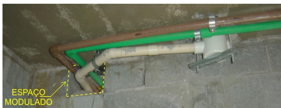
FIGURA 4.22 – Interferência das tubulações horizontais com a alvenaria estrutural. Fonte: Empresa B1.
