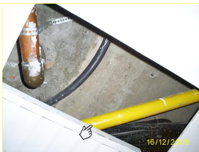
FIGURA 3.20 – Interfaces entre o SPGC e os SPHS, de elétrica, laje e forro. A inconformidade do SPGC (em amarelo) atenta contra a segurança do edifício. Fonte: GNIPPER, 2010.
