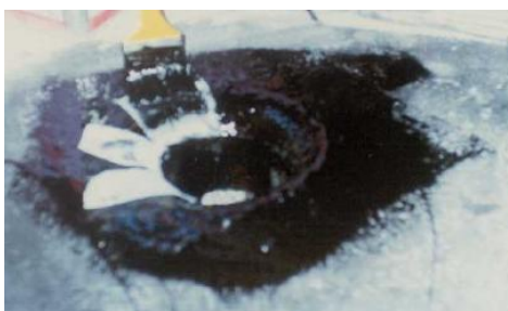
FIGURA 2.7 – Cuidados com os drenos na laje: uso de membrana asfáltica com véu de poliéster. Fonte: BARROS et al., 2006.
