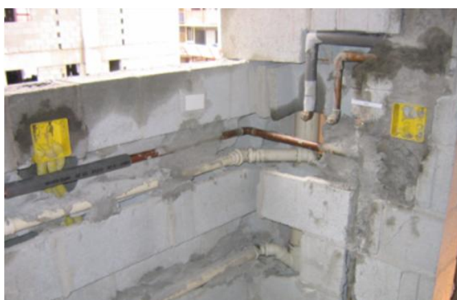
FIGURA 3.8 – Integração da alvenaria com os sistemas prediais sem compatibilização prejudicando o desempenho do sistema da alvenaria.
