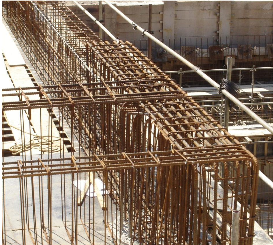
Figura 12 - Região com alta concentração de armadura que requer atenção especial no adensamento para evitar incidências patológicas
