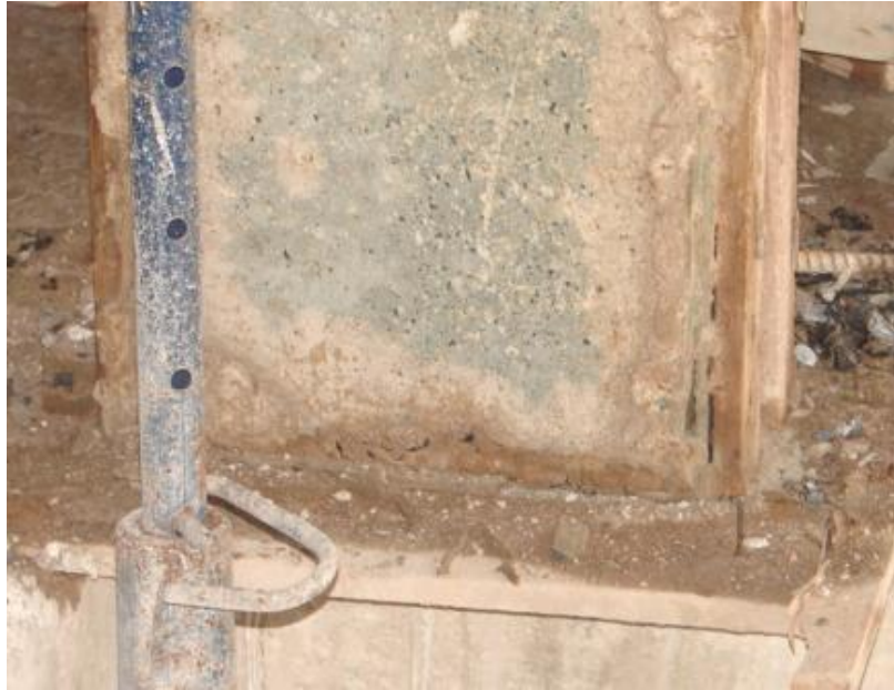
Figura 58 - Adensamento inadequado gerando problemas de bicheira nos pés dos pilares
