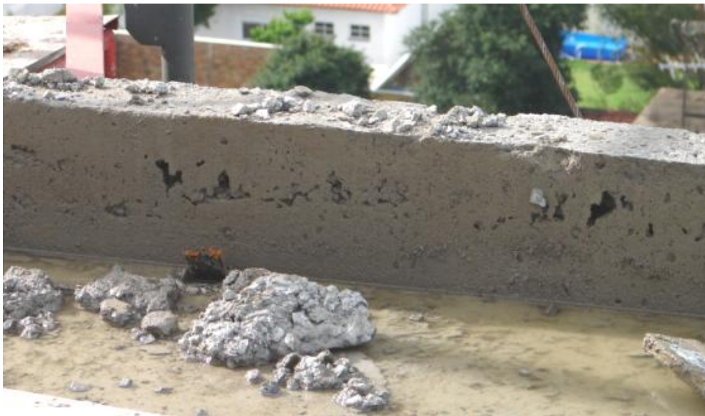
Figura 63 - Vibração do concreto inadequada que ocasionou 'bicheiras'
