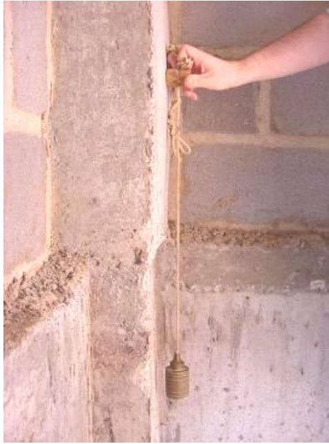
Figura 20 - Pilar fora de prumo em relação ao pavimento inferior Fonte: ALVES, et al , 2006
