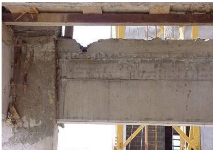
Figura 19 - - Bicheiras na parte superior da viga Fonte: ALVES, et al , 2006
