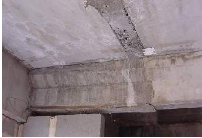
Figura 15 - Desnível da viga Fonte: ALVES, et al., 2006
