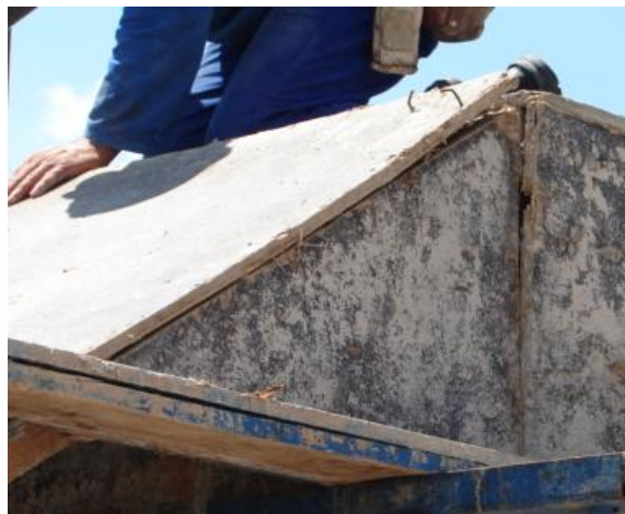
Figura 26 - Fôrma danificada pelo uso inadequado
