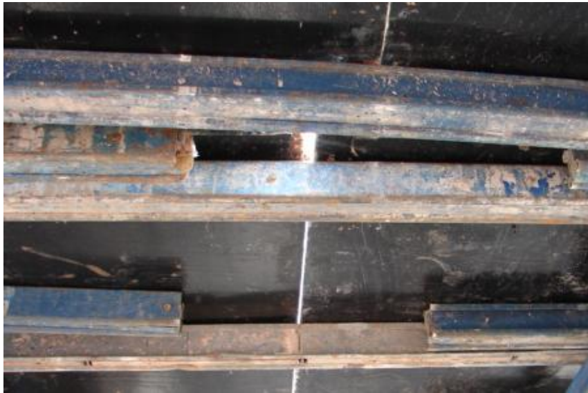
Figura 39 - Fôrmas danificadas que prejudicam a qualidade do serviço a ser executado
