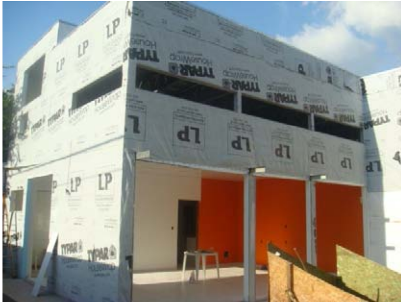
Figura 33: Edificação em LSF vedada com OSB e revestida com manta de polietileno
