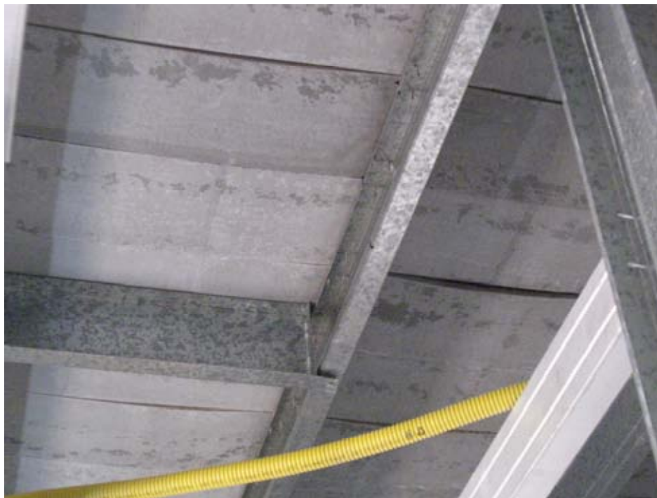
Figura 65: Utilização de placas cimentícias para a sustentação de reservatório de água (detalhe para o empenamento das placas)
