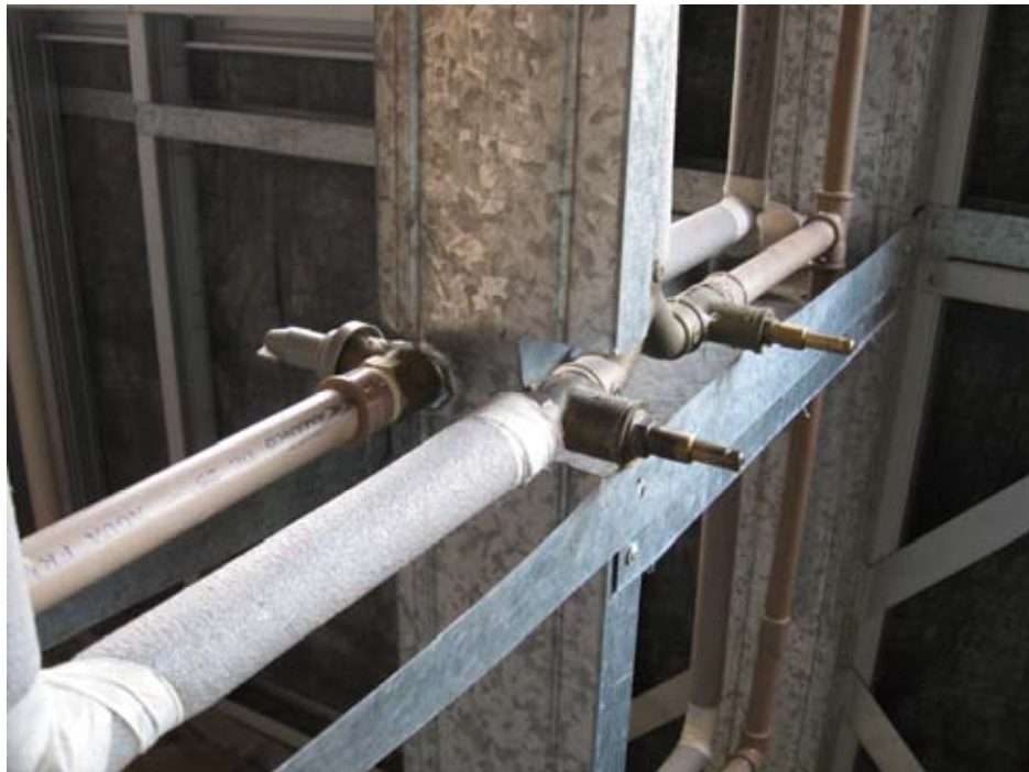
Figura 62: Cortes executados na alma do perfil de aço para a passagem de tubulação hidráulica, sem previsão por parte do projeto estrutural
