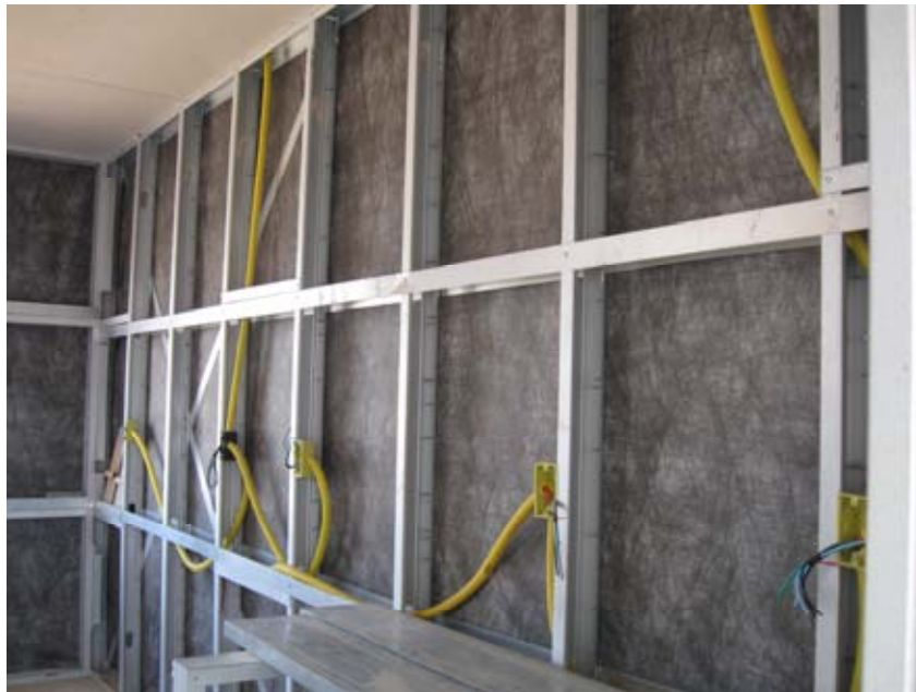
Figura 44: Conduítes para fiação elétrica passando pelos montantes de um painel em LSF
