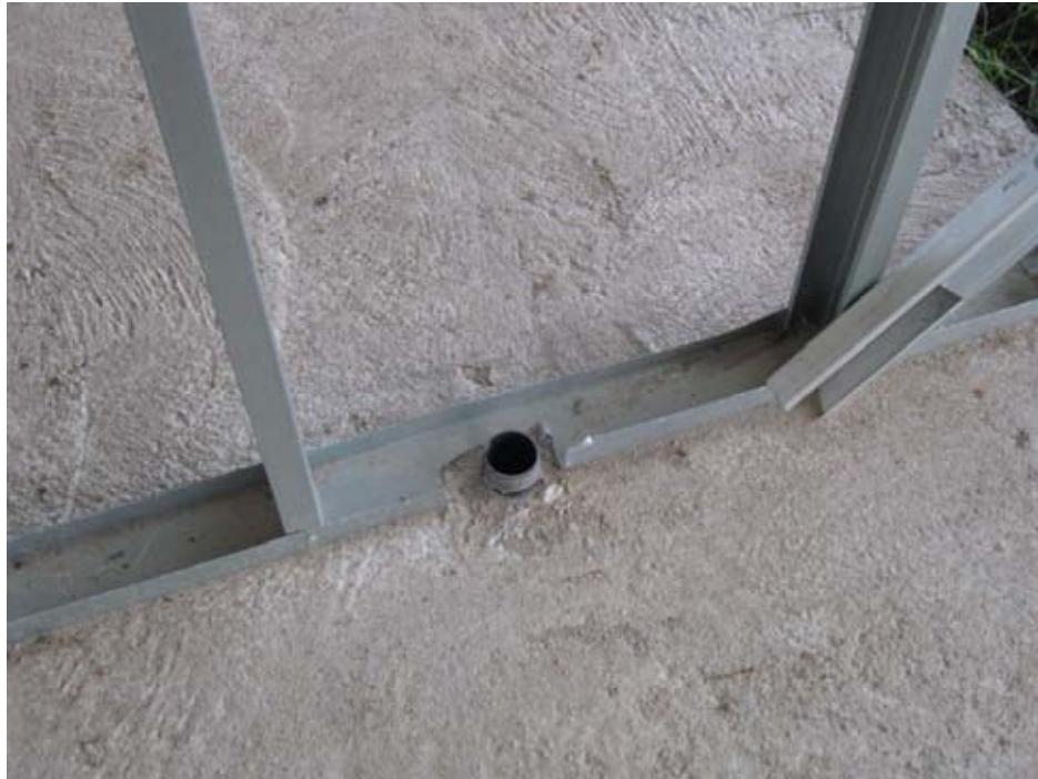
Figura 63: Cortes executados na alma do perfil de aço para a passagem de tubulação elétrica, sem previsão por parte do projeto estrutural
