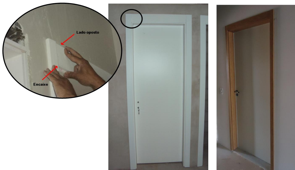
Figura 139 – Solução de ajuste dimensional com alizar superior de 10 cm, obra sem contrapiso (nível zero)
