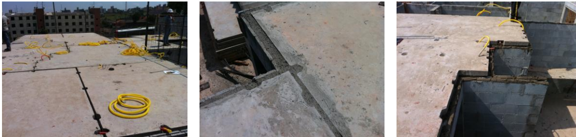
Figura 107 – Lajes nível zero pré-moldadas, encaixadas e fixadas no pavimento, apoiadas sobre as paredes estruturais Fonte: Fotos enviadas pela EMPRESA 4 (Apêndice 2)
