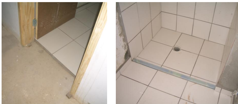
Figura 109 – Desnível entre unidade habitacional e banheiro. Desnível entre banheiro e Box. Fonte: Foto tirada pela autora em visita a obra da EMPRESA 1 (Apêndice 2)
