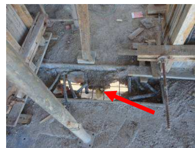
Figura 6.17 – Abertura sem fechamento provisório adequado – Obra 4
