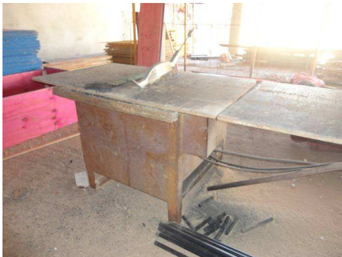
Figura 6.117 – Mesa para serra circular – Obra 6
