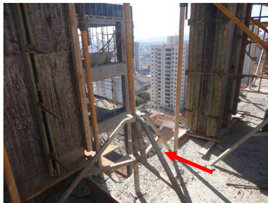
Figura 6.64 – Trecho sem proteção periférica após desforma – Obra 5
