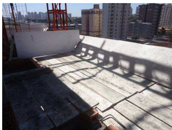
Figura 6.102 – Plataforma de proteção secundária – Obra 6
