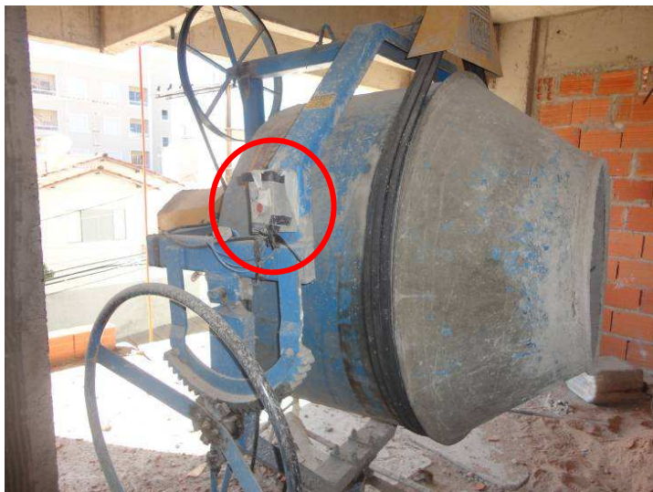
Figura 6.134 – Dispositivo de acionamento de betoneira – Obra 4
