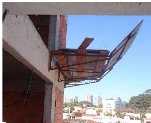
Figura 6.104 – Plataforma de proteção secundária – Obra 4
