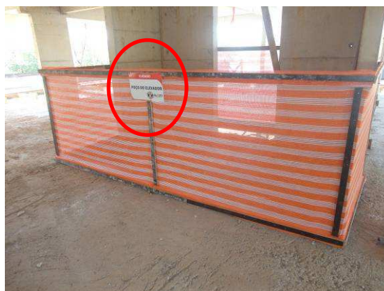
Figura 6.85 – GcR em madeira para proteção do poço do elevador do 3º pavimento – Obra 8
