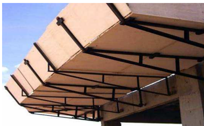
Figura 4.71 – Plataforma de proteção primária - Orman
