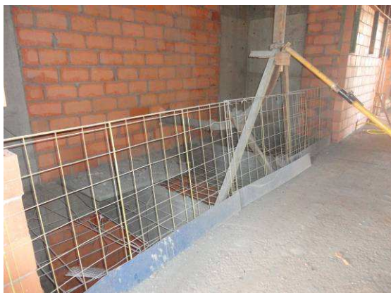
Figura 6.69 – GcR metálico para proteção do poço do elevador – Obra 6
