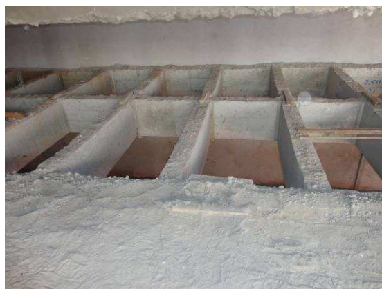
Figura 6.66 – Ausência de GcR em trecho de vigas de travamento – Obra 5
