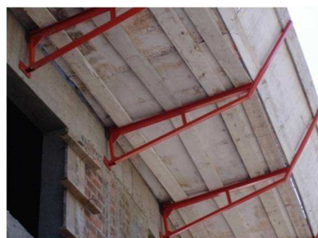
Figura 4.75 - Plataforma de proteção coletiva secundária - Perfilline
