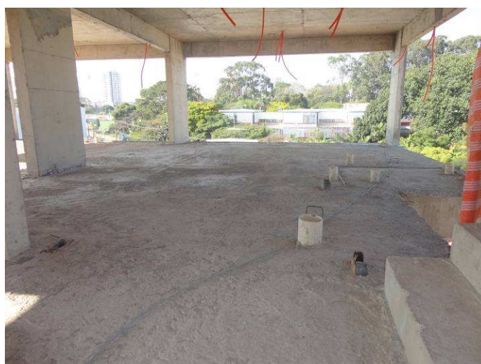
Figura 6.79 – Pavimento sem proteção periférica – Obra 7
