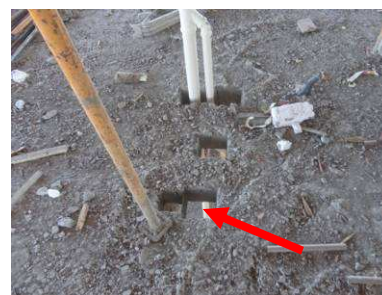
Figura 6.20 – Aberturas na laje sem fechamento provisório – Obra 5
