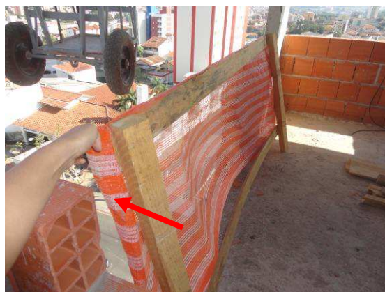
Figura 6.78 – GcR em madeira sem fixação adequada – Obra 7
