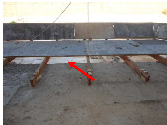
Figura 6.170 – Desnível entre plataforma de proteção e laje – Obra 8
