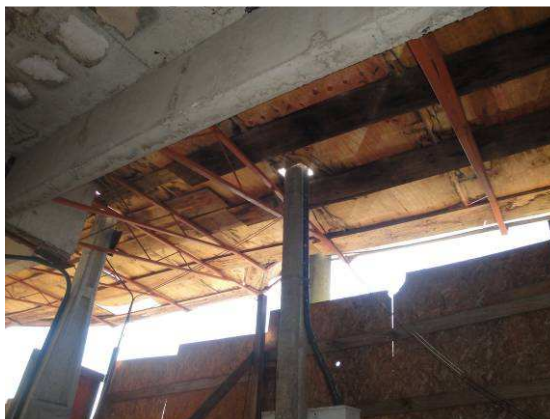
Figura 6.112 – Plataformas de proteção coletiva ultrapassando o limite do terreno – Obra 1
