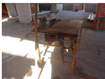
Figura 6.119 – Mesa para serra circular – Obra 7
