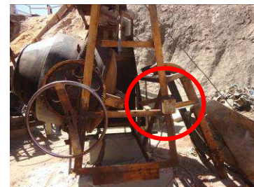
Figura 6.139 – Chave liga-desliga sem proteção – Obra 6
