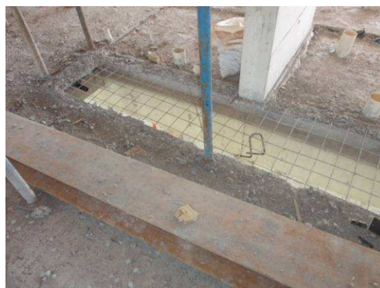
Figura 6.22 – Shaft sem fechamento provisório – Obra 8
