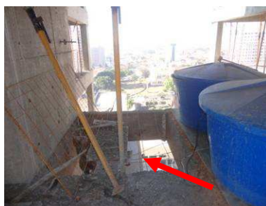
Figura 6.19 - Abertura sem fechamento provisório adequado – Obra 5
