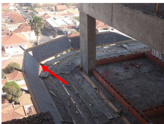
Figura 6.101 – Plataforma de proteção secundária– Obra 5
