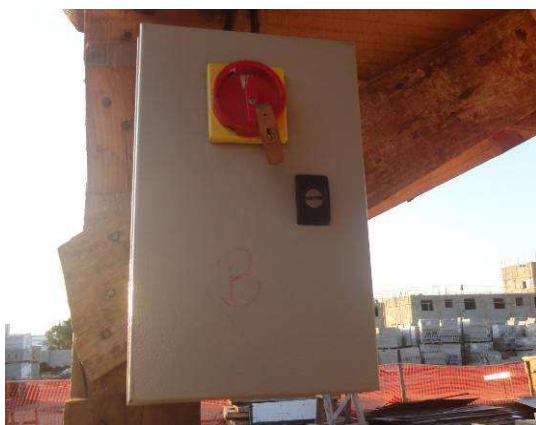
Figura 6.132 – Quadro elétrico individual para equipamento – Obra 3
