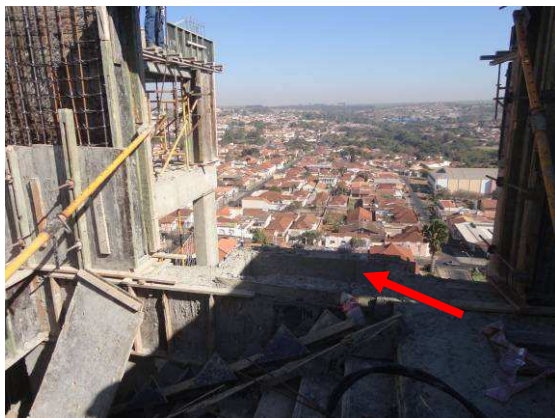
Figura 6.63 – Laje sem proteção periférica após desforma – Obra 5
