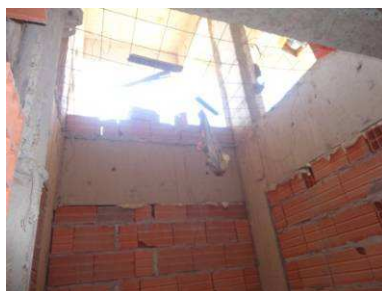
Figura 6.16 - Ausência de fechamento de abertura – Obra 4
