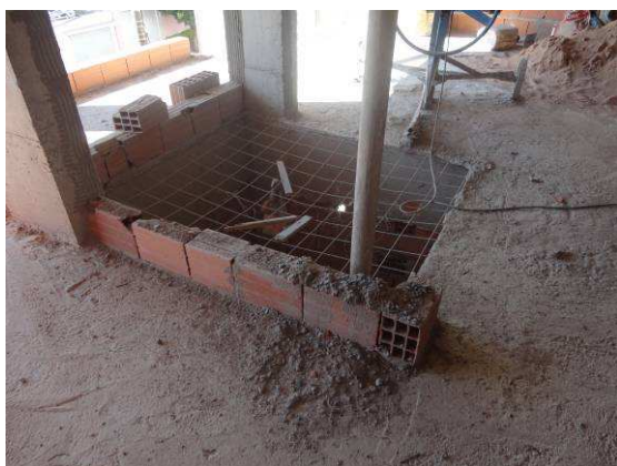
Figura 6.53 – Poço do elevador sem GcR para proteção – Obra 4
