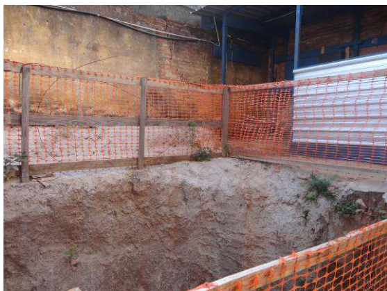
Figura 6.75 – GcR em madeira para a proteção periférica do térreo – Obra 7
