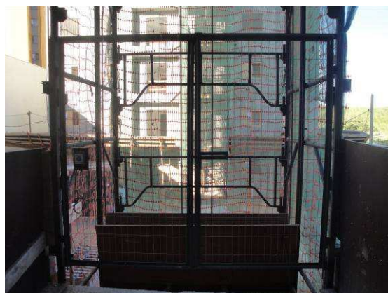
Figura 6.153 – Barreira de entrada para guincho – Obra 2
