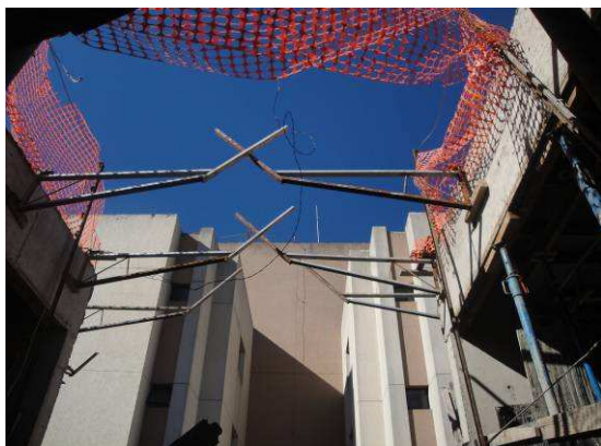
Figura 6.103 – Mão-francesa de sustentação de plataforma de proteção secundária– Obra 1
