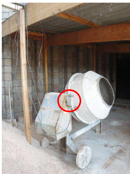
Figura 6.148 – Instalação elétrica da betoneira – Obra 1
