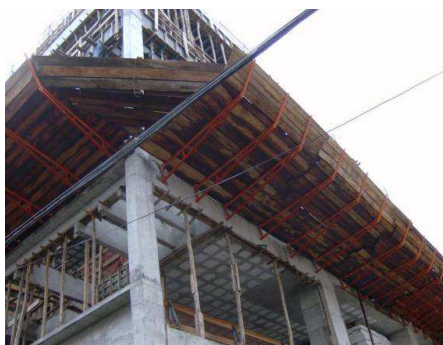
Figura 4.74 – Plataforma de proteção coletiva primária - Perfilline
