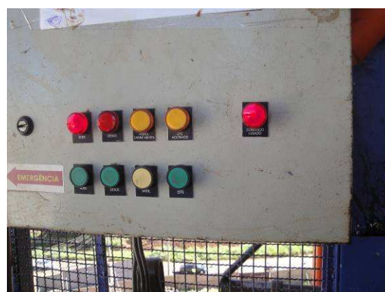
Figura 6.162 – Componentes elétricos de elevador cremalheira protegidos – Obra 1
