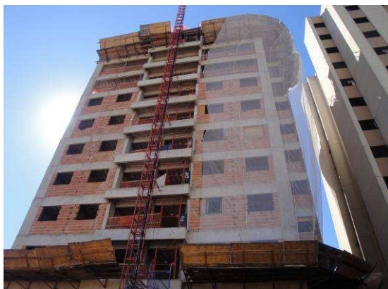
Figura 6.105 – Tela de proteção instalada entre plataformas de proteção – Obra 1
