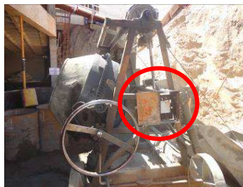
Figura 6.138 – Chave liga-desliga para betoneira com proteção – Obra 6
