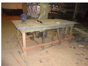
Figura 6.118 – Mesa para serra circular – Obra 5
