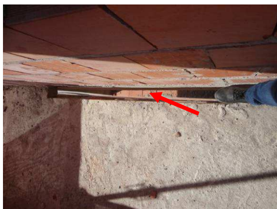
Figura 6.21 – Shaft sem fechamento provisório – Obra 7
