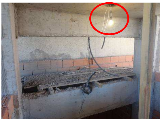
Figura 6.146 – Fiação elétrica exposta – Obra 4
