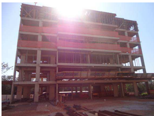
Figura 6.80 – Torre com guarda-corpo apenas em dois pavimentos – Obra 8
