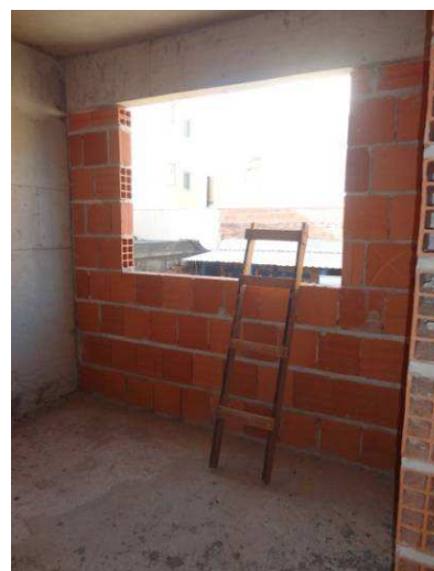
Figura 6.26 – Escada de mão – Obra 7
