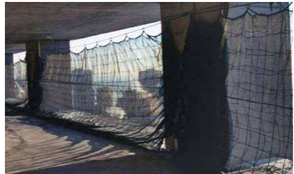
Figura 4.49 - Sistema rede vertical do chão ao teto
