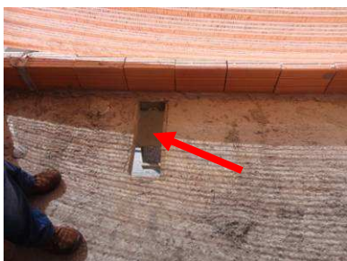
Figura 6.15 – Falta de fechamento de abertura – Obra 4
