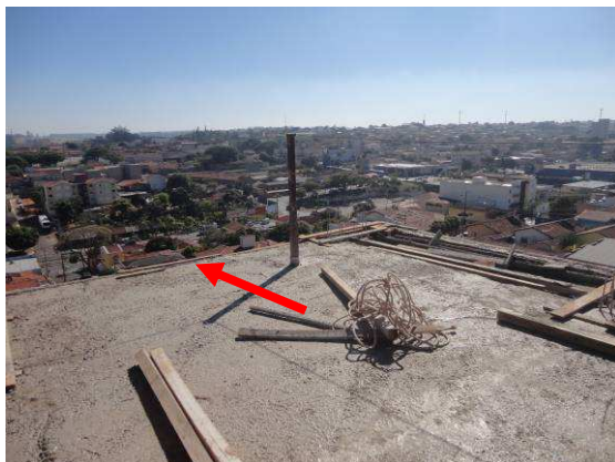
Figura 6.57 – Laje sem sistema de proteção periférica – Obra 4
