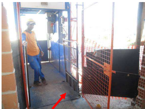
Figura 6.158 – Rampa e GcR de acesso a elevador cremalheira – Obra 1
