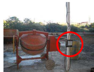
Figura 6.131 – Chave liga-desliga distante de betoneira – Obra 2
