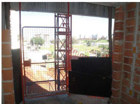
Figura 6.152 – Barreira de entrada para elevador cremalheira – Obra 1
