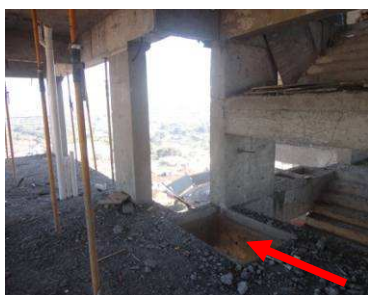
Figura 6.18 – Ausência de fechamento de abertura de piso – Obra 5
