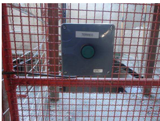
Figura 6.161 – Dispositivo de acionamento do elevador cremalheira – Obra 5
