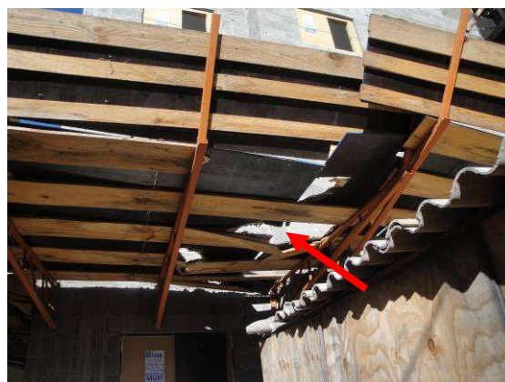
Figura 6.114 – Estrado da plataforma de proteção danificado – Obra 2
