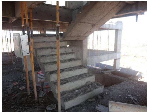
Figura 6.28 – Escada de movimentação – Obra 5
