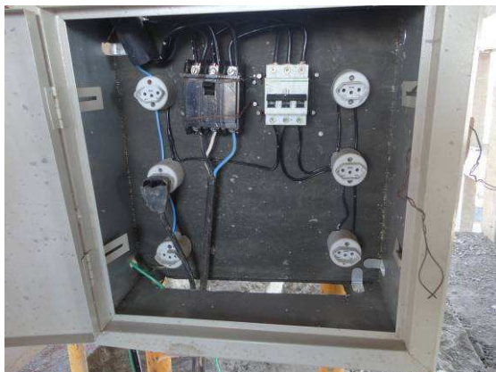
Figura 6.135 – Quadro elétrico para uso de equipamentos – Obra 5
