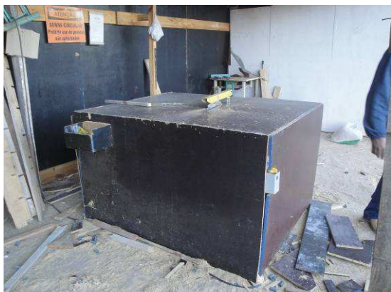
Figura 6.115 – Mesa para serra circular – Obra 2
