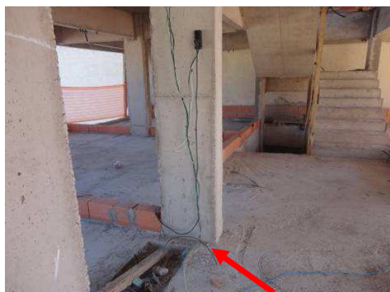
Figura 6.147 – Fiação mal organizada – Obra 4
