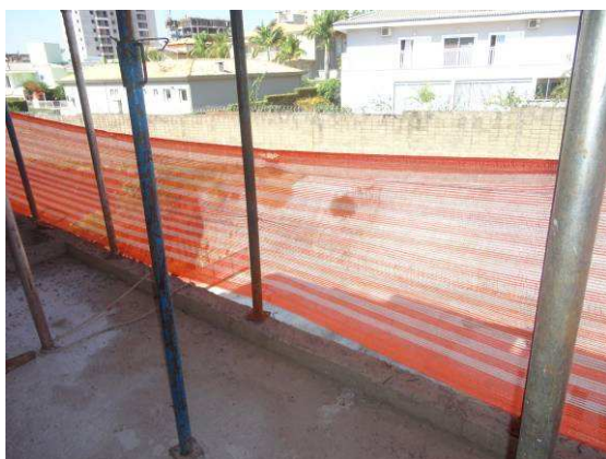
Figura 6.82 – Tela para GcR sem fixação adequada – Obra 8
