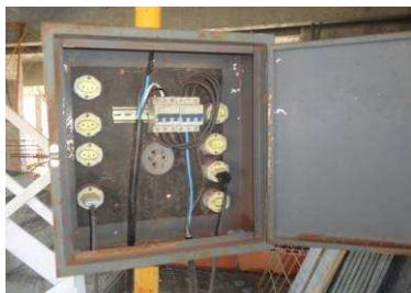
Figura 6.137 – Quadro elétrico para uso de equipamentos – Obra 6
