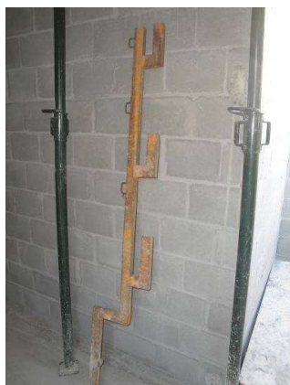
Figura 6.37 – Montante metálico de GcR – Obra 2
