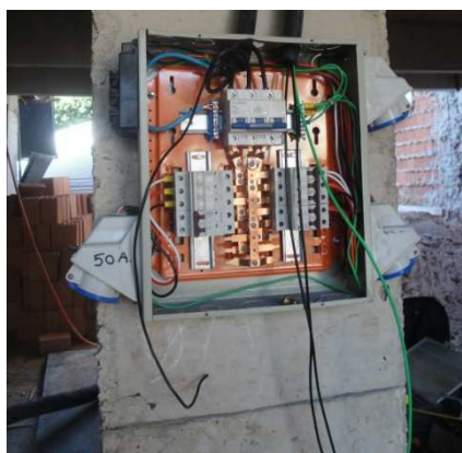
Figura 6.149 – Quadro elétrico de entrada de energia – Obra 4
