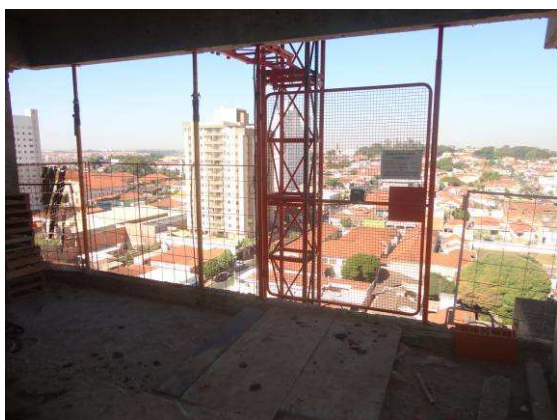
Figura 6.154 – Barreira de entrada para elevador cremalheira – Obra 5
