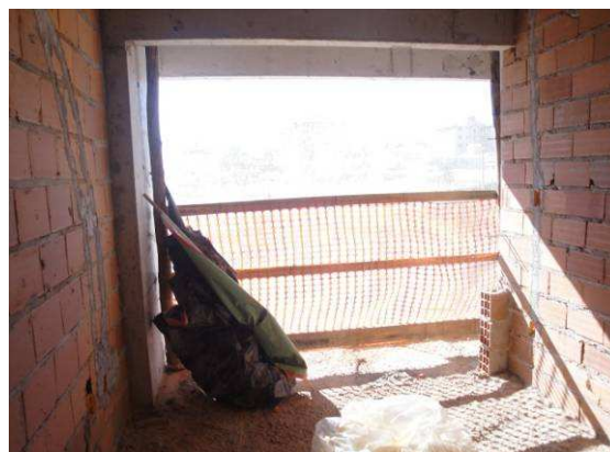
Figura 6.34 – GcR com espaçamento entre montantes elevado – Obra 1
