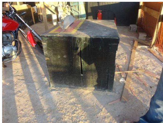
Figura 6.116 – Mesa para serra circular – Obra 3
