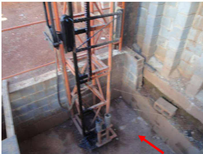
Figura 6.151 – Base da torre do elevador cremalheira – Obra 1
