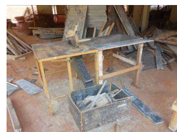
Figura 6.120 – Mesa para serra circular – Obra 8
