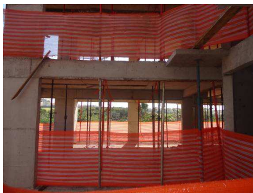
Figura 6.81 – GcR em tela no 3º e 4º pavimentos – Obra 8
