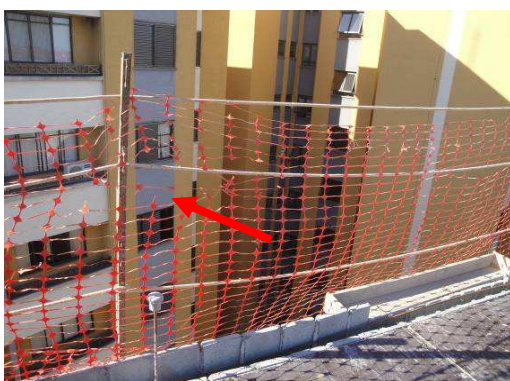
Figura 6.39 – Tela de fechamento de GcR rasgada – Obra 2
