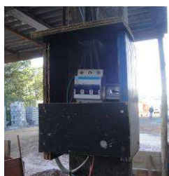
Figura 6.129 – Disjuntores para acionamento de betoneira – Obra 2
