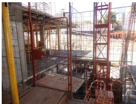
Figura 6.155 – Barreira de entrada para elevador cremalheira – Obra 6
