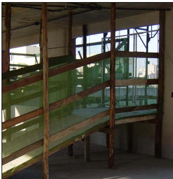
Figura 37 – Proteção lateral e corrimão provisório de madeira em rampa
