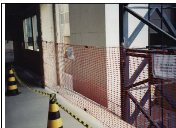
Figura 31 - Barreira com cabo de aço e rede, devidamente sinalizada
