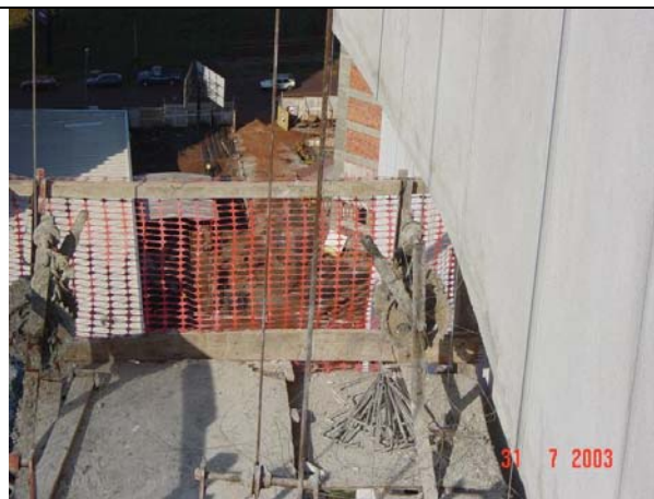
Figura 30 - GcR sem altura e sem travessa intermediária recomendadas por norma
