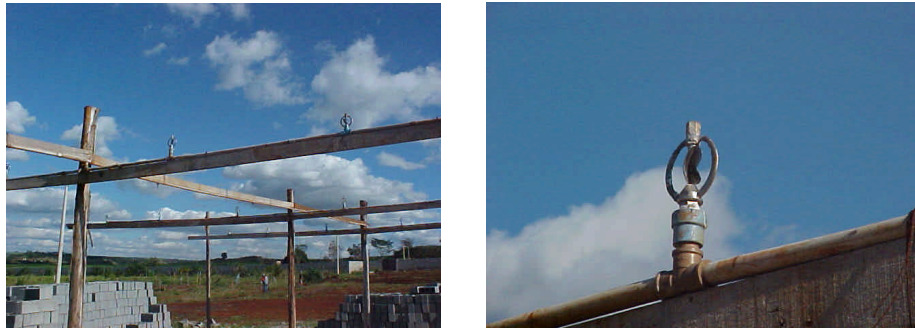
Figura 17: Fotos de conjunto de aspersores para cura de blocos
