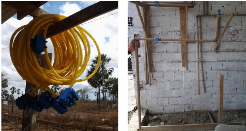
Figura 62 – Instalações elétricas e hidráulicas
