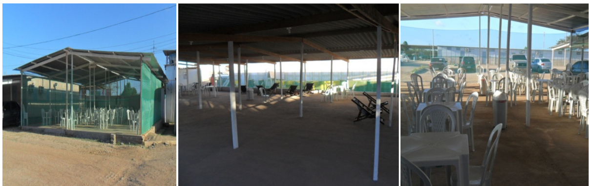
Figura 52 – Instalações provisórias para áreas de vivência – refeitório e lazer
