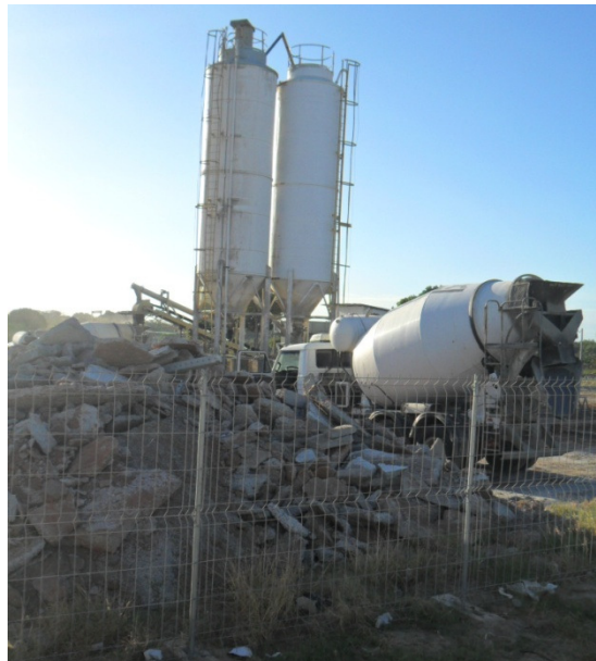
Figura 49 – Central de concreto
