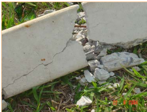
Figura 2.19 – mesma vigota, sem armadura adicional. (Arquivo do autor).
