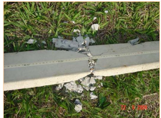
2.18 – vigota quebrada no meio do vão de 5,68m. Arquivo do autor.
