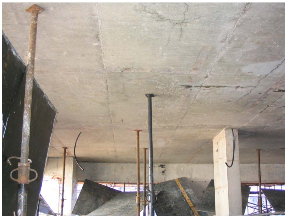
Foto 4.1 Deslocamento na primeira laje do estudo de caso (vista pelas trincas e fissuras)
