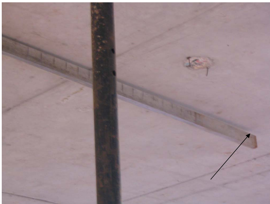
Foto 4. 2 Deslocamento na primeira laje do estudo de caso (vista pela régua)
