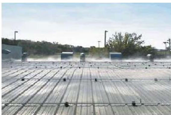
Figura 2.17: Vista do Sistema Evafrio em operação. ( www.evafrio.com.br )
