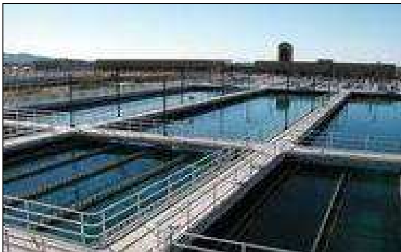
Figura 4 – Lagoas de Tratamento
