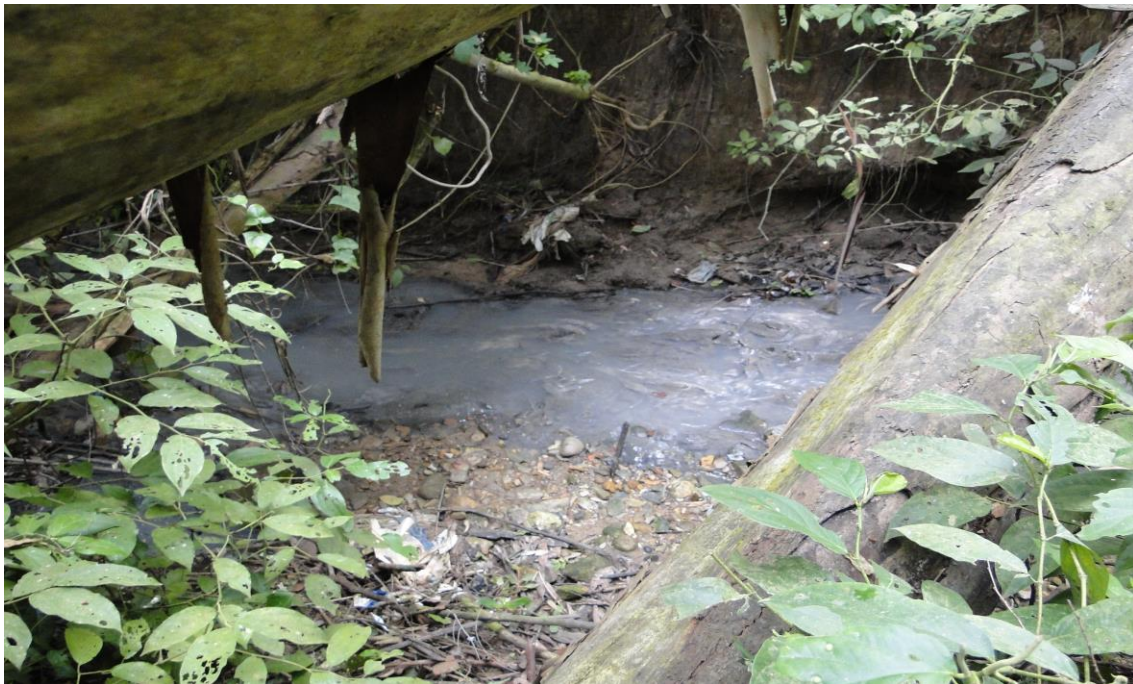
Figura 3: Água com esgoto passando no interior do parque.
