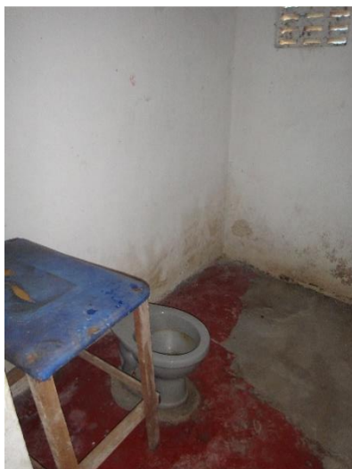
Foto 6: Banheiro sem água encanada. Foto: Lúcio Verçoza, maio de 2014.
