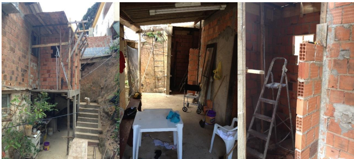
Figura 24: Da esquerda para direita, primeira foto externa da ampliação, segunda foto do terraço superior com o novo banheiro ainda em construção no fundo e terceira foto da entrada do novo banheiro para seu interior.
