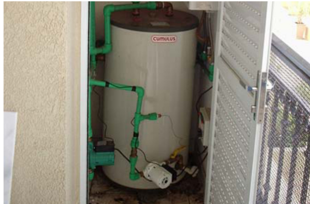
Figura 8 – Sistema Central Privado (sistema conjugado a gás) – com recirculação
