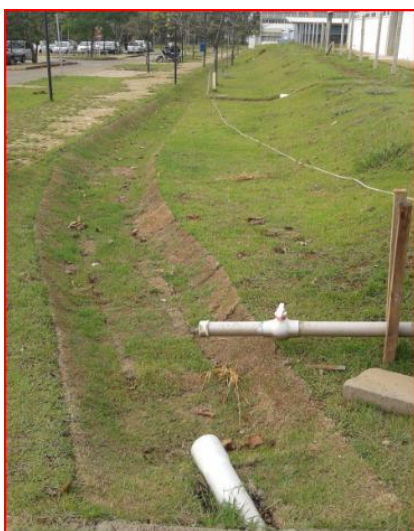
Figura 14. Tubulação de saída do plano de infiltração no início do canal gramado. Fonte: Autor
