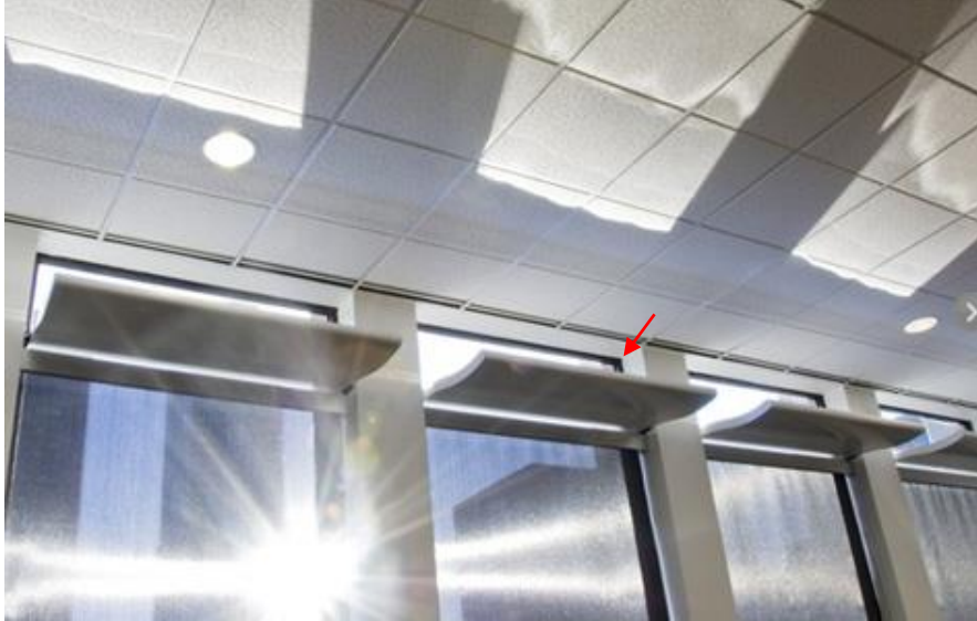
Figura 17: Prateleira de luz instalada internamente à edificação
