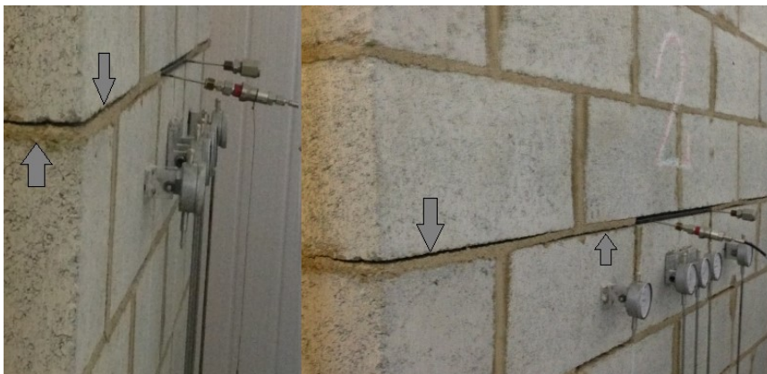
Figura 118: Fissuras na parede ao redor da região testada.
