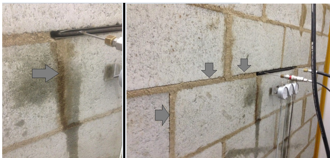
Figura 121: Fissuras na parede 3 após o ensaio.
