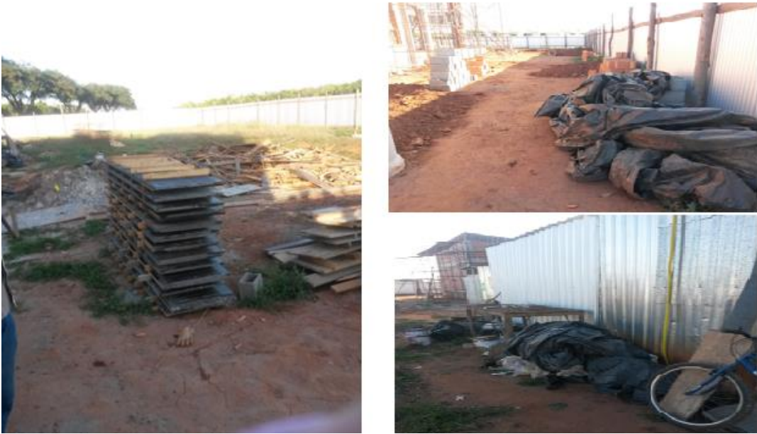
Figura 67 - Antes do treinamento – material espalhado pelo canteiro de forma desordenada
