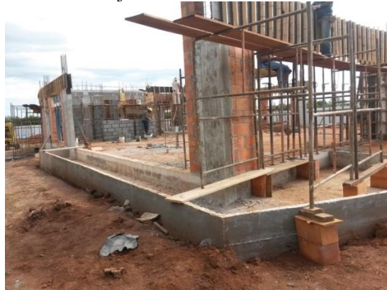
Figura 69 - Antes do treinamento – sujeira e desnível em volta da obra prejudicando o ‘tráfego’
