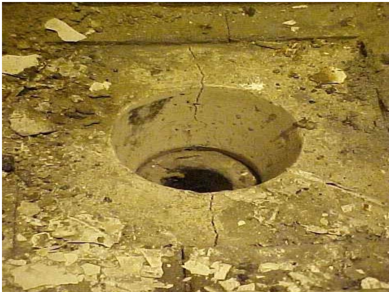
Figura 4.31 - Trincamentos em uma sede de válvula de concreto alumina-magnésia, após a primeira queima em uma panela de siderurgia.
