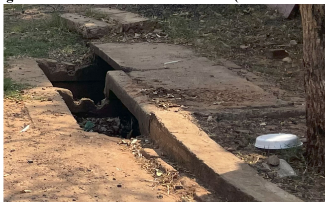
Figura 27: Boca de lobo no Ferradura (Vila do Sucesso)
