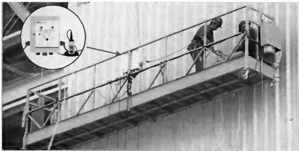
Figura 39. Plataforma de trabalho com destaque para o quadro de comando.
