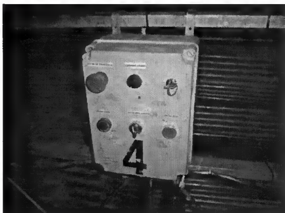
Figura 40. Quadro de comando Mecan
