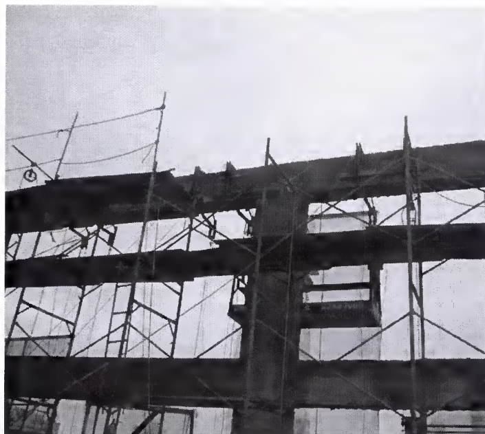
Figura 68. Local de uso do andaime suspenso leve
