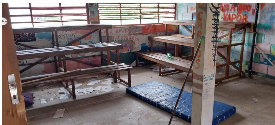
Imagem 23 - Sala da Prédio DCE Livre- arrombada - foto de fevereiro de 2025
