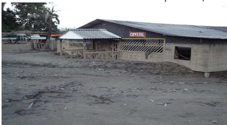
Figura 8 – Fachada de um comércio com sedimentos pós-inundação.
