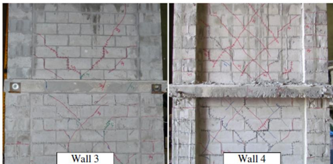
Figura 37 - Comparação entre o caminho das fissuras no primeiro andar das paredes 3 e 4
