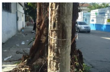
Figura 12 - Poste em mau estado.
