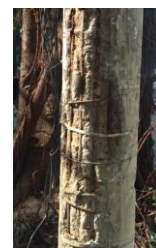
Figura 13 - Poste em mau estado com recorte.
