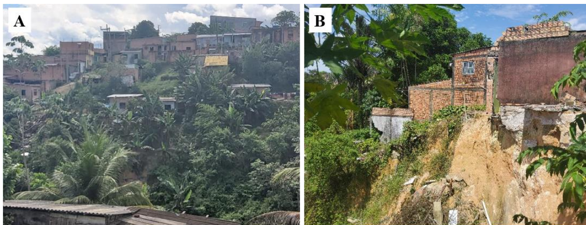
Figura 41 - A) Vista de encosta parcialmente desmatada com ocupações irregulares, em corte e aterros, com cicatriz de deslizamento na base, sem identificação de localização; B) Cicatriz de deslizamento antigo e sinais de movimentação no terreno, sem identificação de localização.
